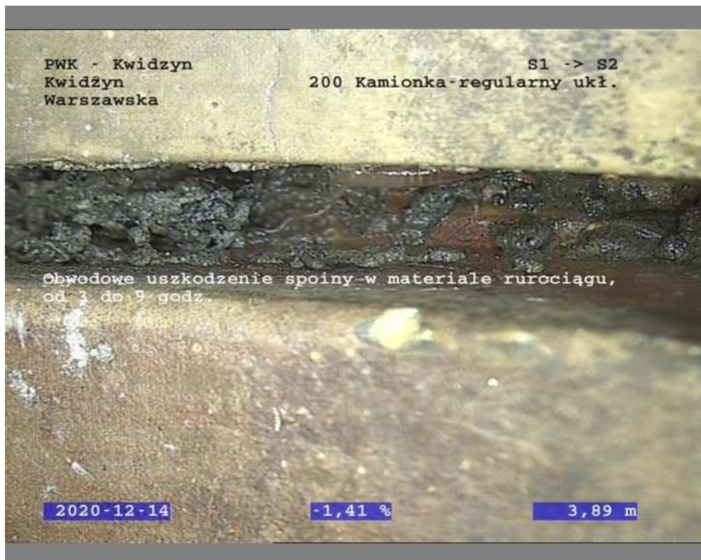
FOT. 3-2 WIDOK POŁĄCZENIA – KIELICH RURY BRAK USZCZELNIENIA (dżdżownica)
