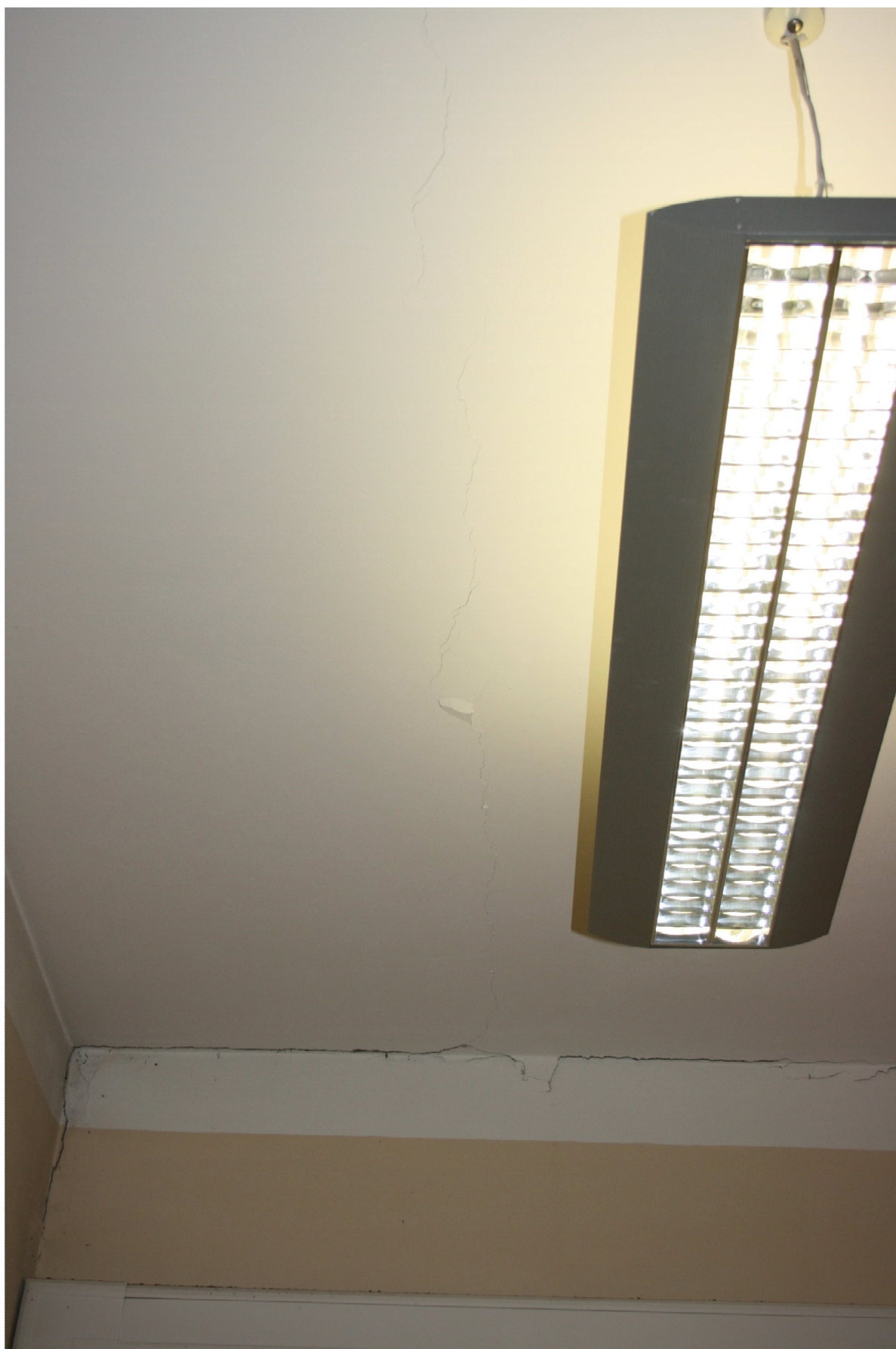
FOT. 1-5 ZARYSOWANIE STROPU OD STRONY POMIESZCZENIA 1.2
