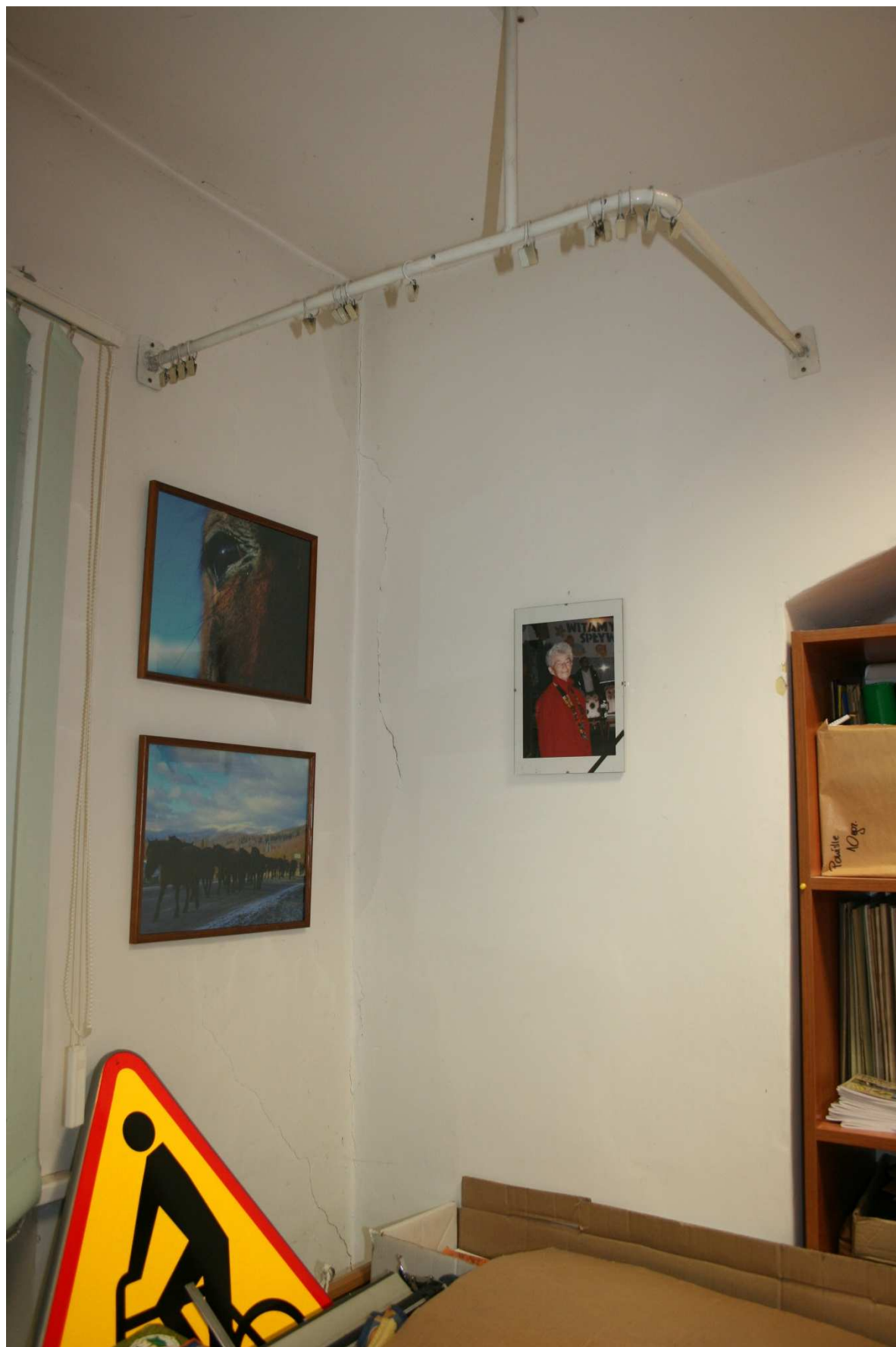
FOT. 0-3 ZARYSOWANIE ZEWNĘTRZNEJ ŚCIANY POPRZECZNEJ I STYKU ŚCIANY PODŁUŻNEJ I POPRZECZNEJ W POMIESZCZENIU 0.8
