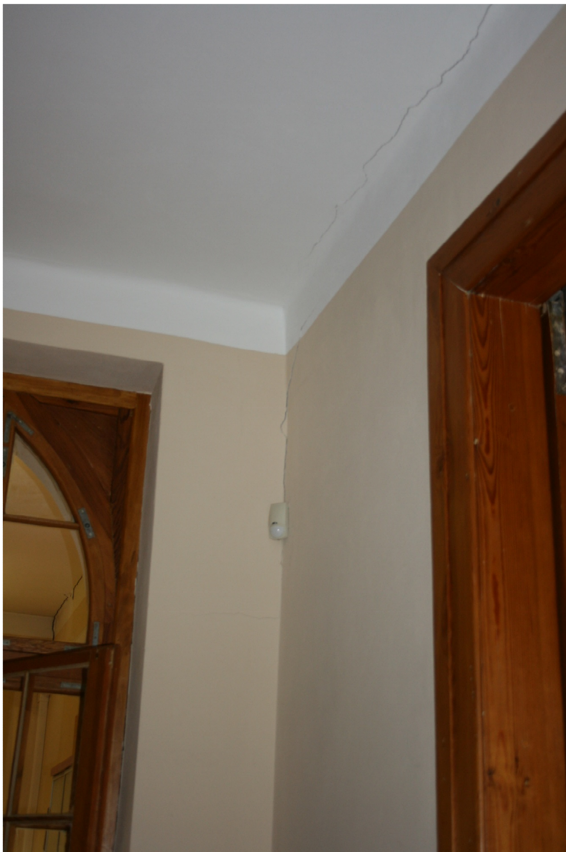
FOT. 1-6 ZARYSOWANIE ŚCIANY I STROPU POPRZECZNEJ OD STRONY POMIESZCZENIA 1.1
