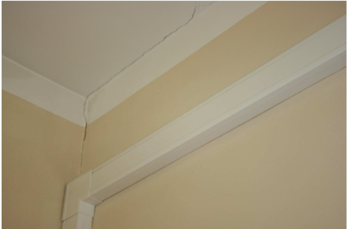
FOT. 1-4 ZARYSOWANIE ZEWNĘTRZNEJ ŚCIANY POPRZECZNEJ I STROPU OD STRONY POMIESZCZENIA 1.2 – WRZESIEŃ 2015 r.
