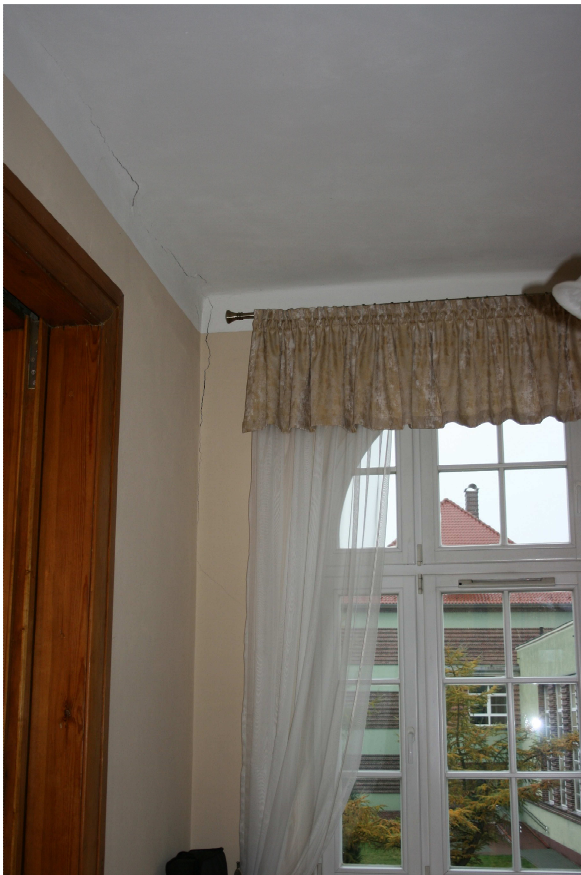
FOT. 1-8 ZARYSOWANIE ŚCIANY I STROPU POPRZECZNEJ OD STRONY POMIESZCZENIA 1.1
