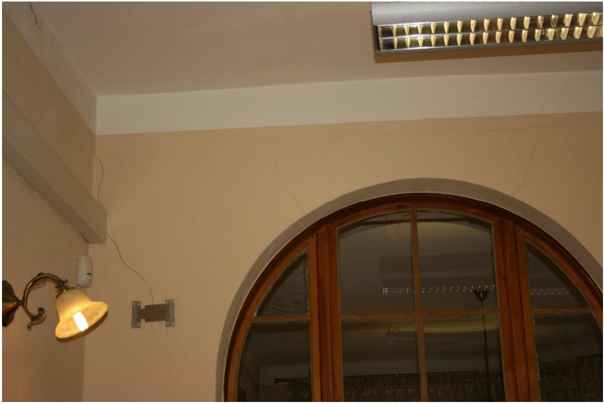
FOT. 1-1 ZARYSOWANIE ŚCIANY POPRZECZNEJ OD STRONY POMIESZCZENIA 1.2
