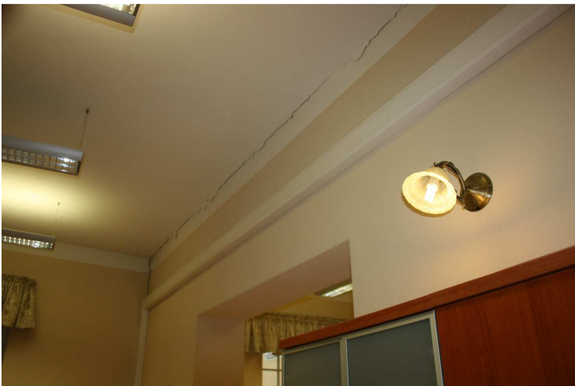
FOT. 1-3 ZARYSOWANIE STROPU OD STRONY POMIESZCZENIA 1.2
