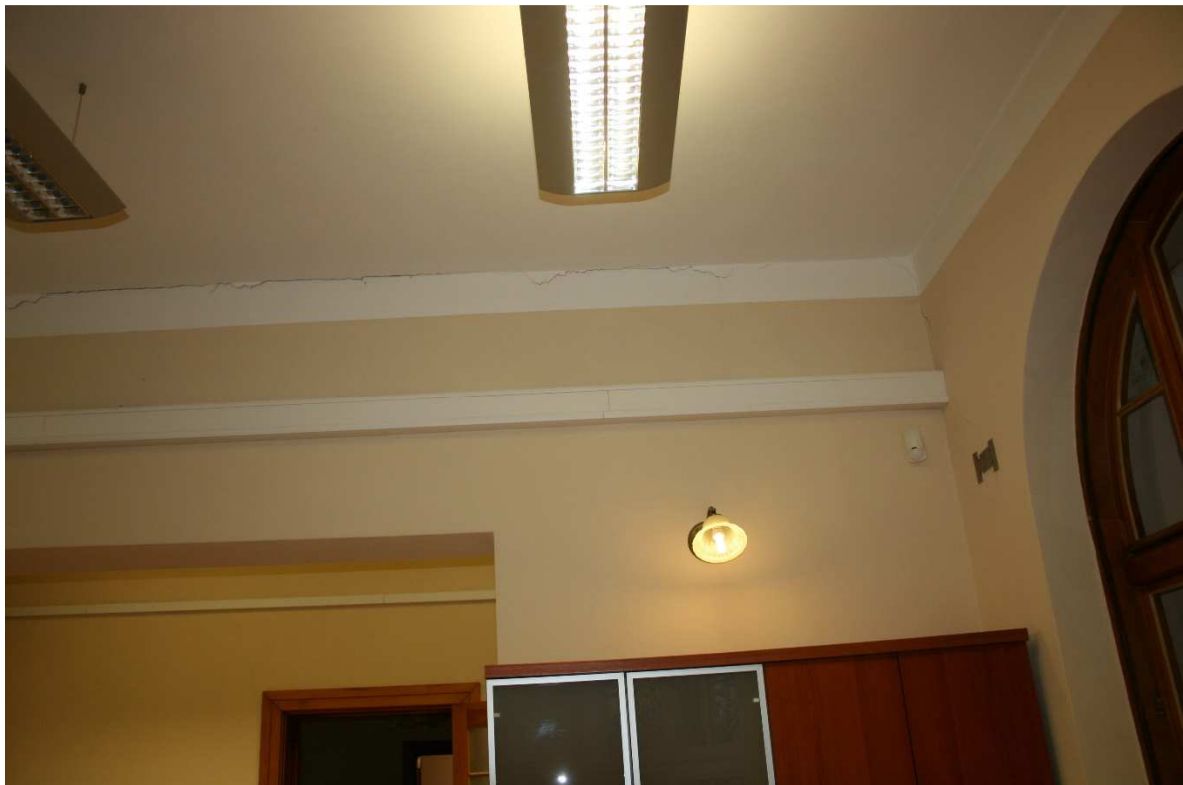
FOT. 1-2 ZARYSOWANIE STROPU OD STRONY POMIESZCZENIA 1.2
