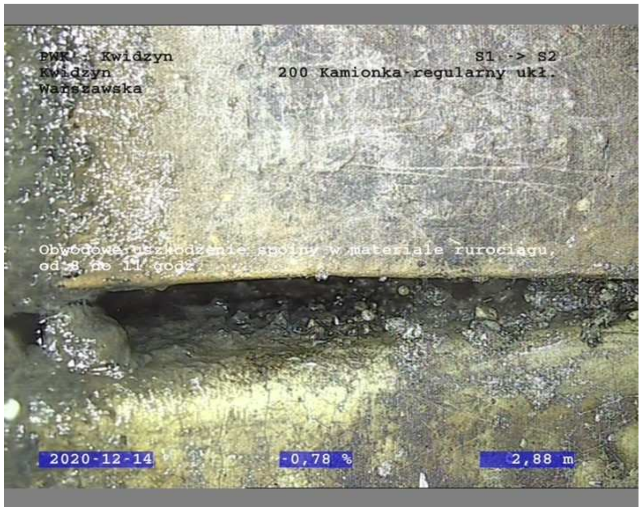
FOT. 3-2 WIDOK POŁĄCZENIA – KIELICH RURY BRAK USZCZELNIENIA
