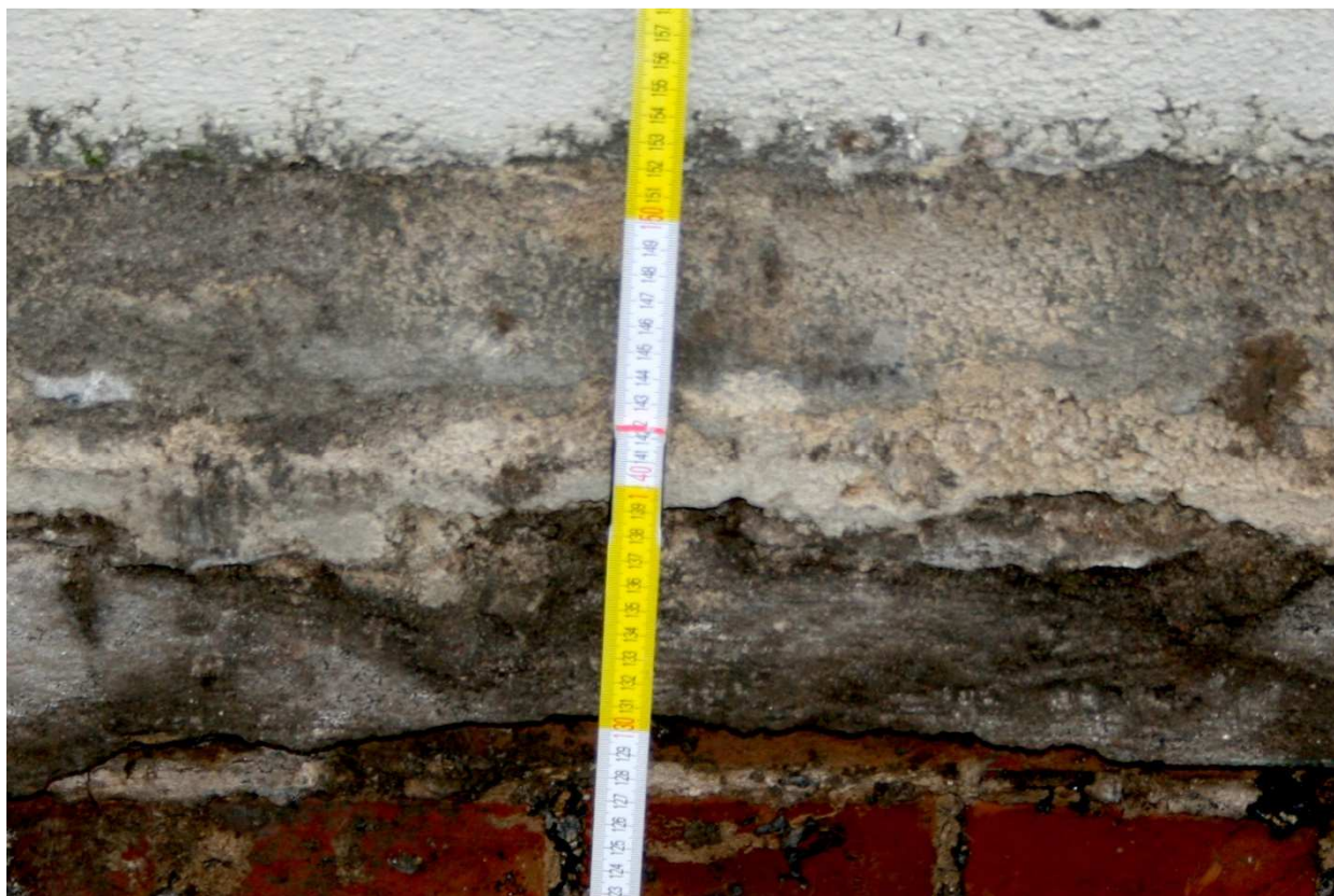
FOT. O-3 ODKRYWKA NR 1 GŁĘBOKOŚĆ POSADOWIENIA ŁAW ca. 150 cm
