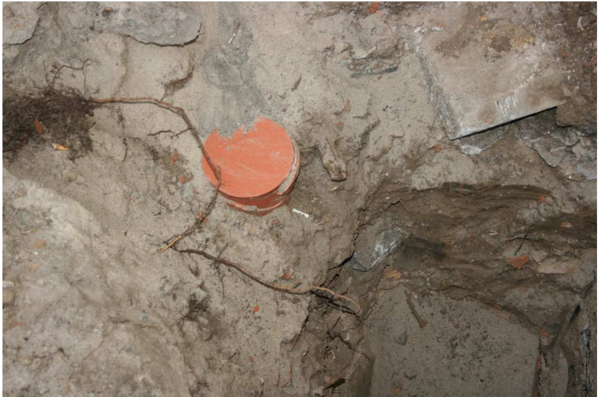
FOT. O-9 ZLIKWIDOWANY ODPIŁYW WÓD OPADOWYCH Z RURY SPUSTOWEJ
