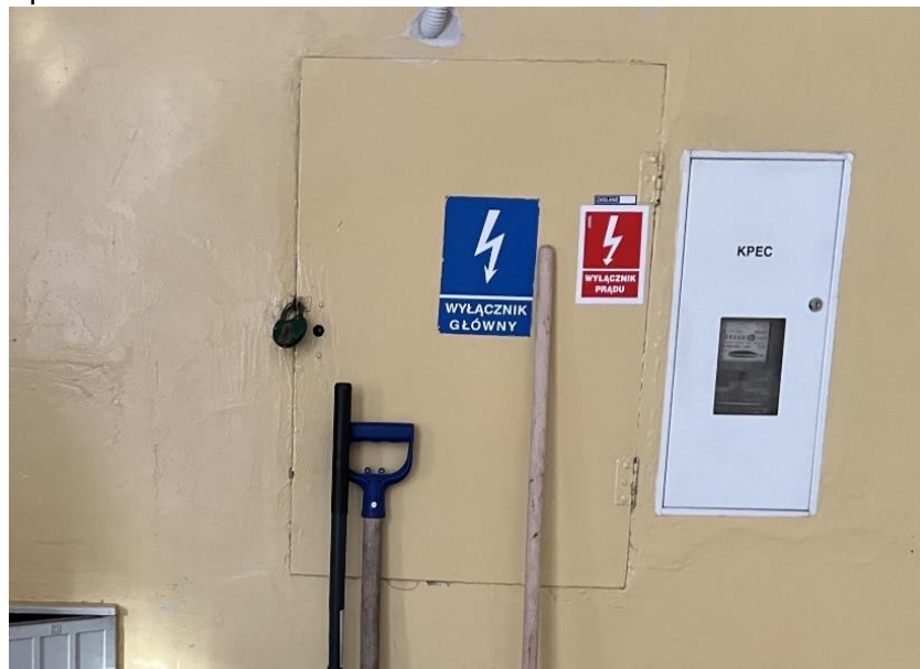
Rysunek 3.13.a. Zdjęcie istniejącego układu pomiarowo-rozliczeniowego – widok szaf frontowych.
