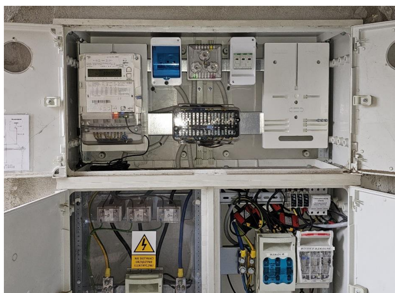
Rysunek 3.5.b. Zdjęcie istniejącego układu pomiarowo-rozliczeniowego – widok wnętrza szaf.
