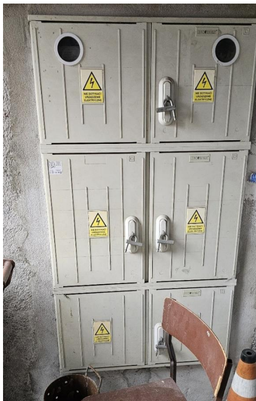
Rysunek 3.5.a. Zdjęcie istniejącego układu pomiarowo-rozliczeniowego – widok szaf frontowych.
