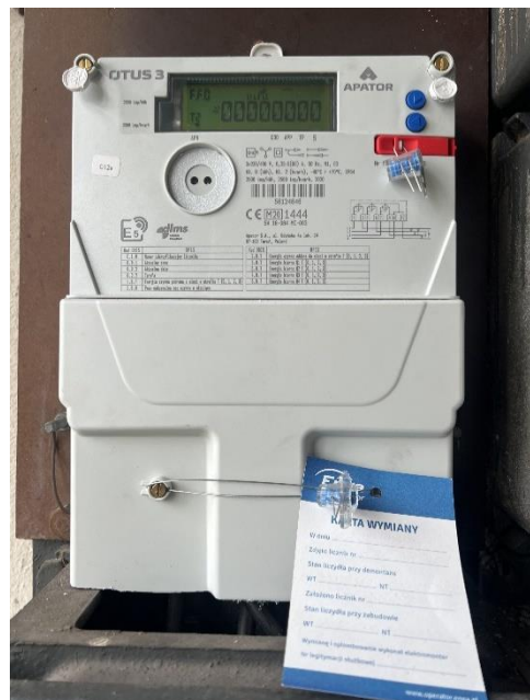
Rysunek 3.15.b. Zdjęcie istniejącego układu pomiarowo-rozliczeniowego – widok licznika energii elektrycznej.
