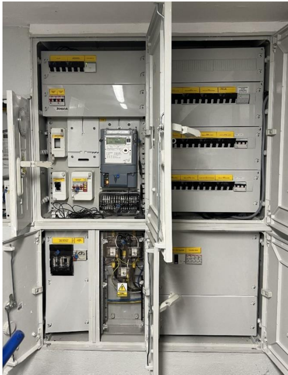
Rysunek 3.2.b. Zdjęcie istniejącego układu pomiarowo-rozliczeniowego – widok wnętrza szaf.
