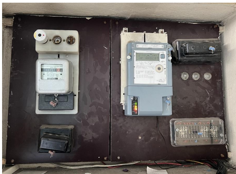
Rysunek 3.4.b. Zdjęcie istniejącego układu pomiarowo-rozliczeniowego – widok wnętrza szaf.
