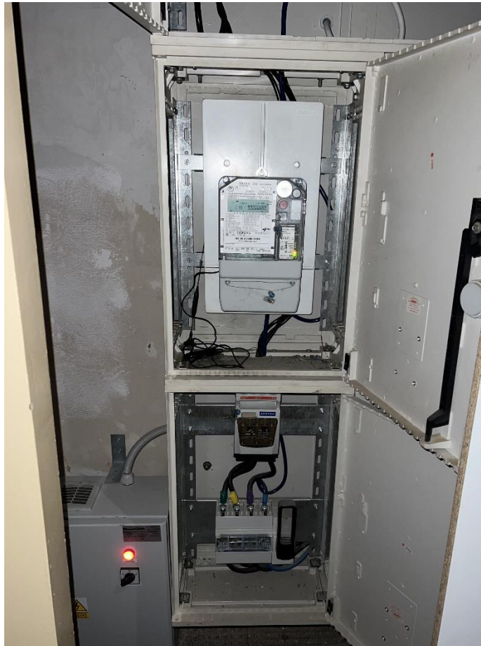
Rysunek 3.9.b. Zdjęcie istniejącego układu pomiarowo-rozliczeniowego – widok wnętrza szaf.
