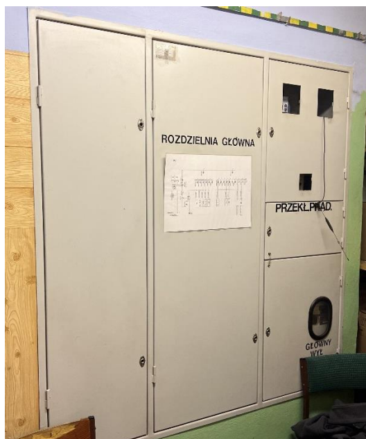
Rysunek 3.3.a. Zdjęcie istniejącego układu pomiarowo-rozliczeniowego – widok szaf frontowych.
