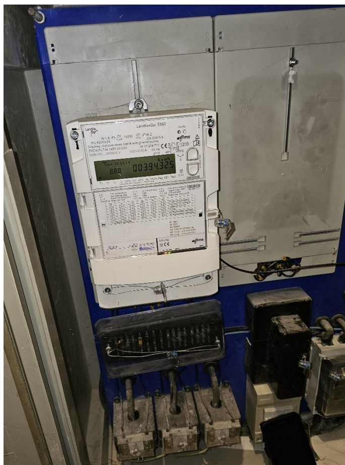
Rysunek 3.16. Zdjęcie istniejącego układu pomiarowo-rozliczeniowego – widok licznika energii elektrycznej.
