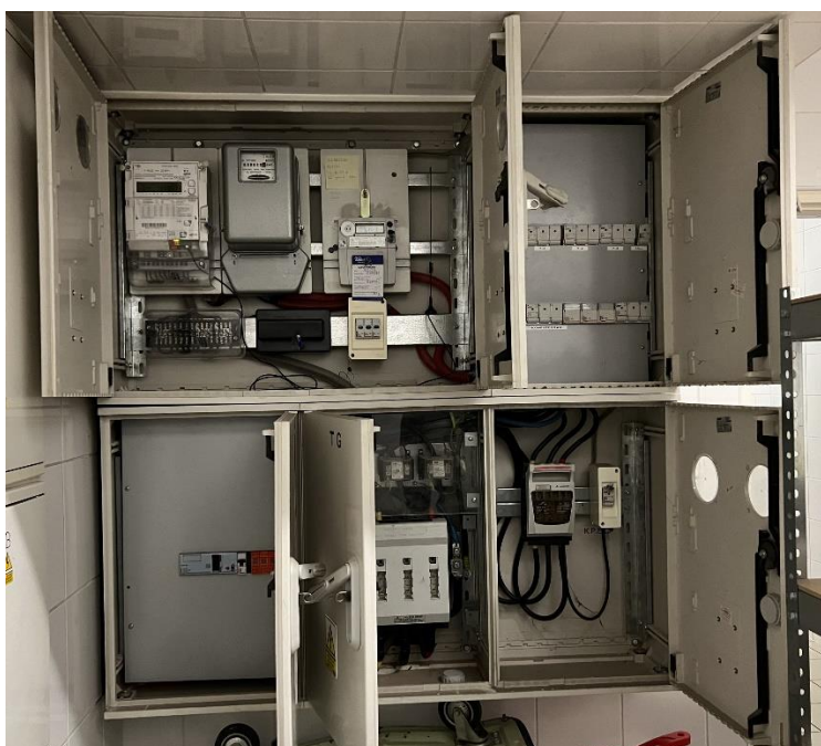
Rysunek 3.7.b. Zdjęcie istniejącego układu pomiarowo-rozliczeniowego – widok wnętrza szaf.
