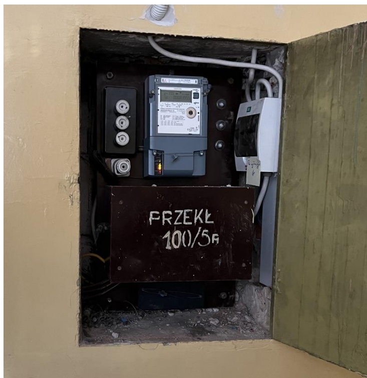
Rysunek 3.13.b. Zdjęcie istniejącego układu pomiarowo-rozliczeniowego – widok wnętrza szaf.
