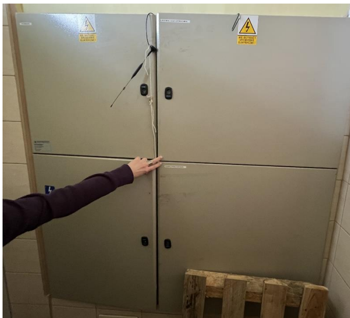
Rysunek 3.17.a. Zdjęcie istniejącego układu pomiarowo-rozliczeniowego – widok szaf frontowych.
