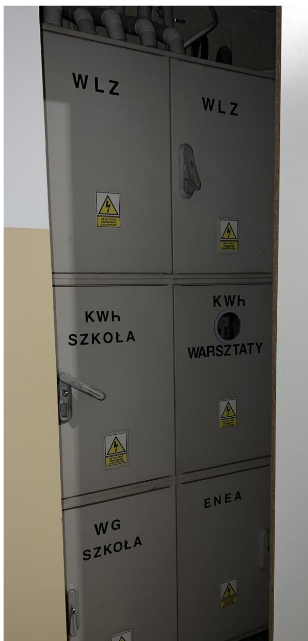
Rysunek 3.9.a. Zdjęcie istniejącego układu pomiarowo-rozliczeniowego – widok szaf frontowych.
