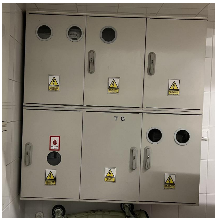
Rysunek 3.7.a. Zdjęcie istniejącego układu pomiarowo-rozliczeniowego – widok szaf frontowych.
