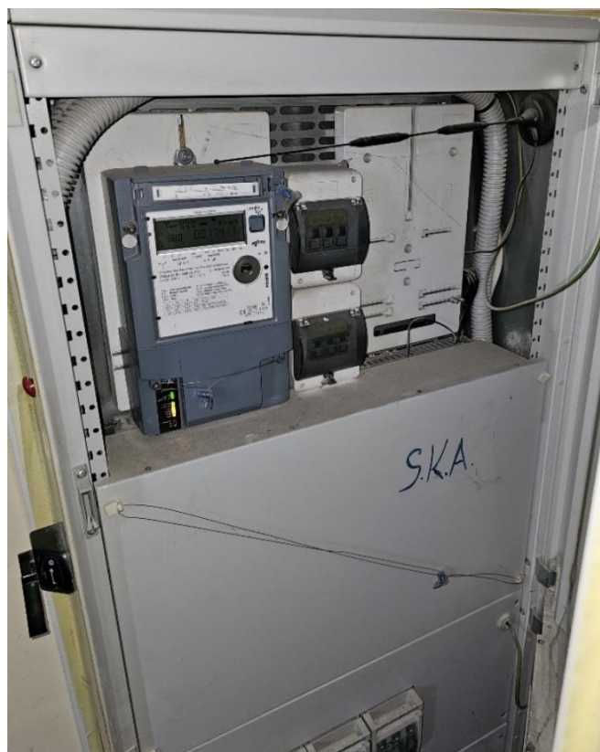
Rysunek 3.14. Zdjęcie istniejącego układu pomiarowo-rozliczeniowego – widok wnętrza szaf.
