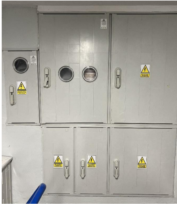
Rysunek 3.2.a. Zdjęcie istniejącego układu pomiarowo-rozliczeniowego – widok szaf frontowych.
