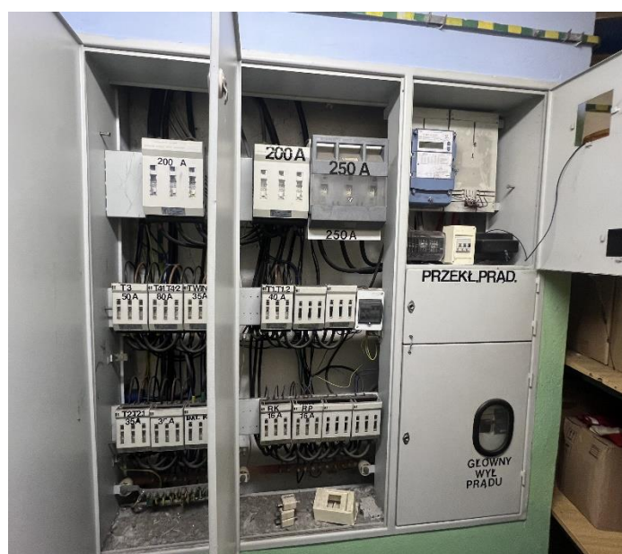
Rysunek 3.3.b. Zdjęcie istniejącego układu pomiarowego – widok wnętrza szaf.
