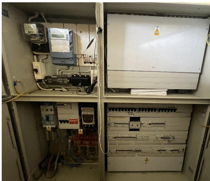
Rysunek 3.17.b. Zdjęcie istniejącego układu pomiarowo-rozliczeniowego – widok wnętrza szaf.
