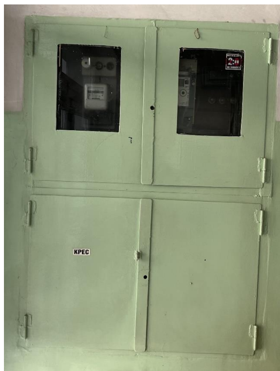
Rysunek 3.4.a. Zdjęcie istniejącego układu pomiarowo-rozliczeniowego – widok szaf frontowych.
