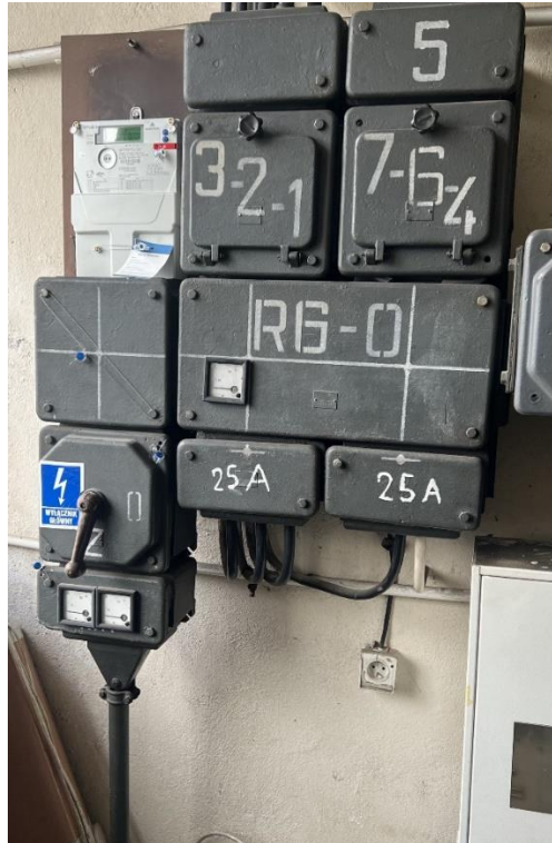
Rysunek 3.15.a. Zdjęcie istniejącego układu pomiarowo-rozliczeniowego – widok szaf frontowych.
