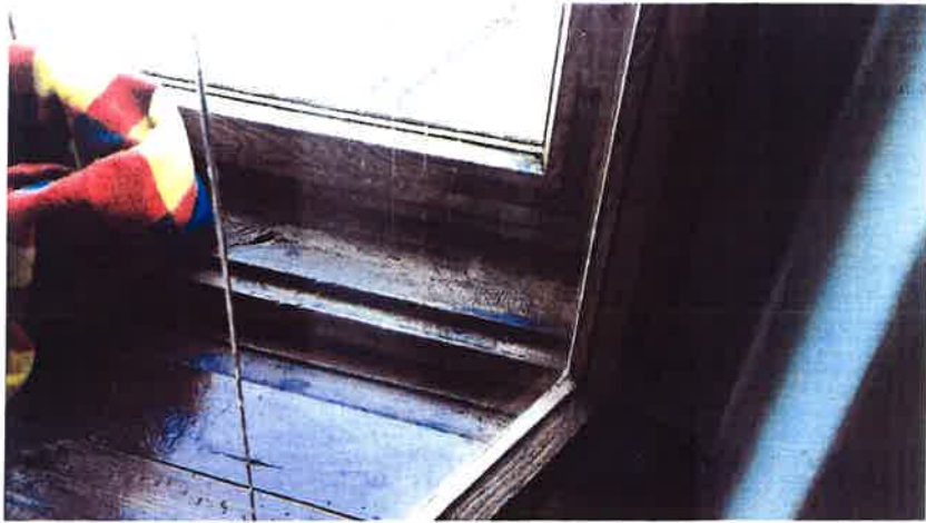
FOTO 13 - zdjęcie od wewnątrz okna skrzynkowego na parterze
