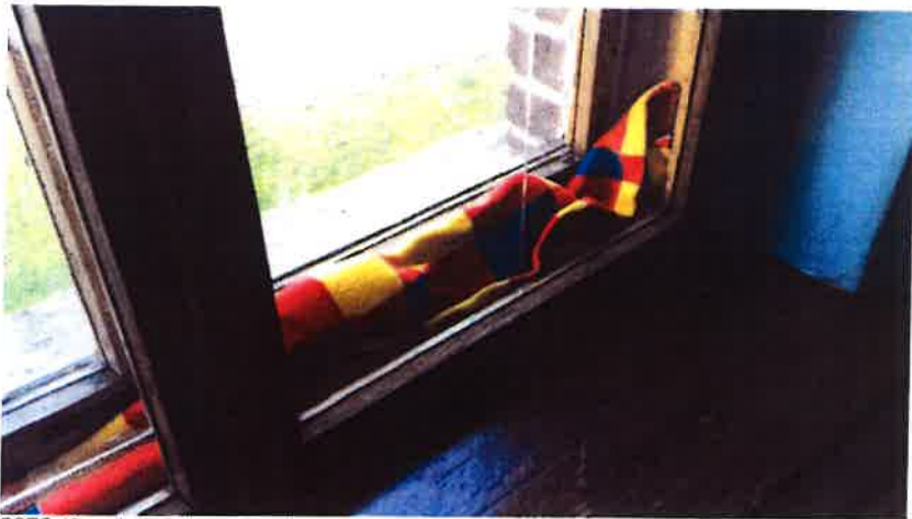
FOTO 12 - zdjęcie od wewnątrz okna skrzynkowego na parterze
