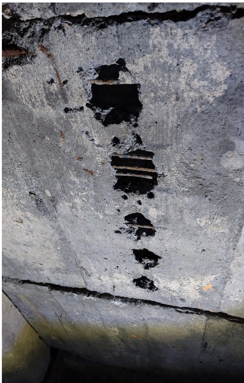
Fot. nr 5. Wygląd spodu płyt stropowych
