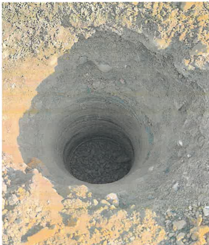
Ilustracja 4: Wykop przedstawiający stan wierzchniej oraz głębszej warstwy podbudówki 2
