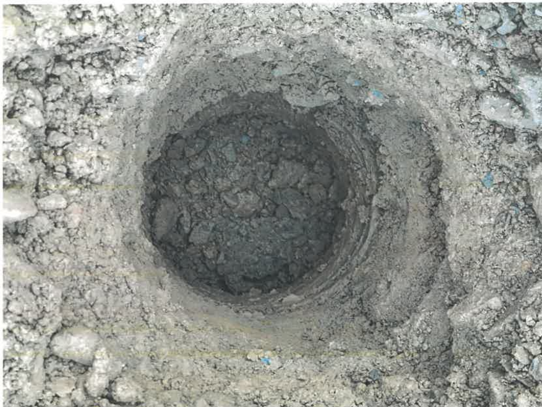
Ilustracja 6: Wykop przedstawiający stan wierzchniej oraz głębszej warstwy podbudówki
