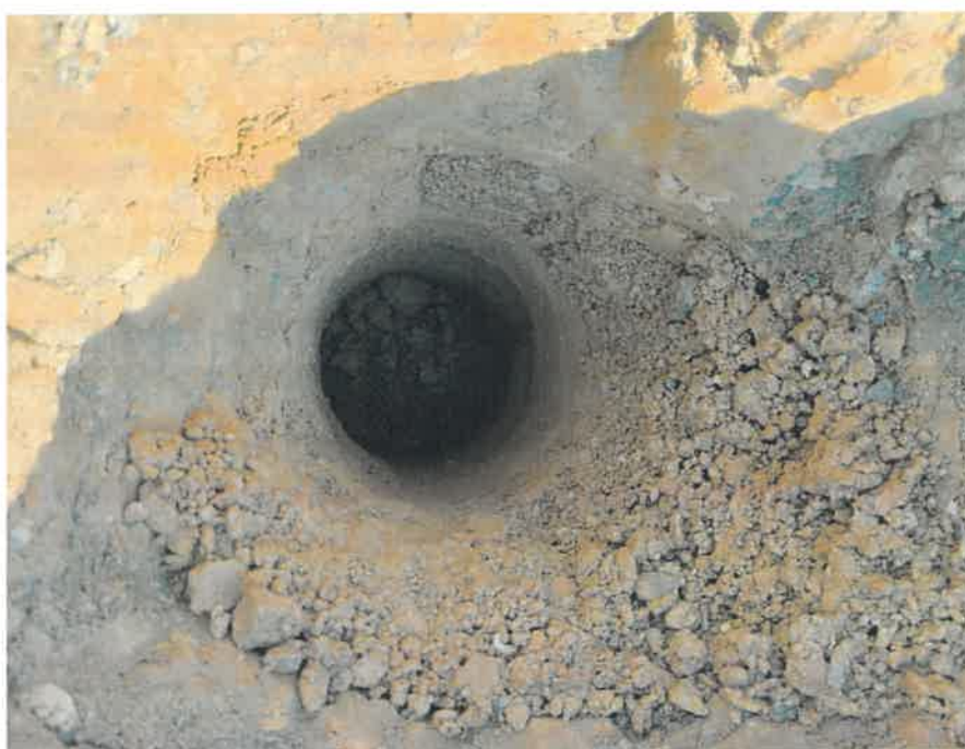
Ilustracja 5: Wykop przedstawiający stan wierzchniej oraz głębszej warstwy podbudówki
