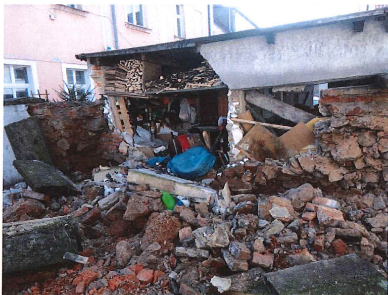
Fot. 2 – widok zawalonego obiektu od strony północnej
