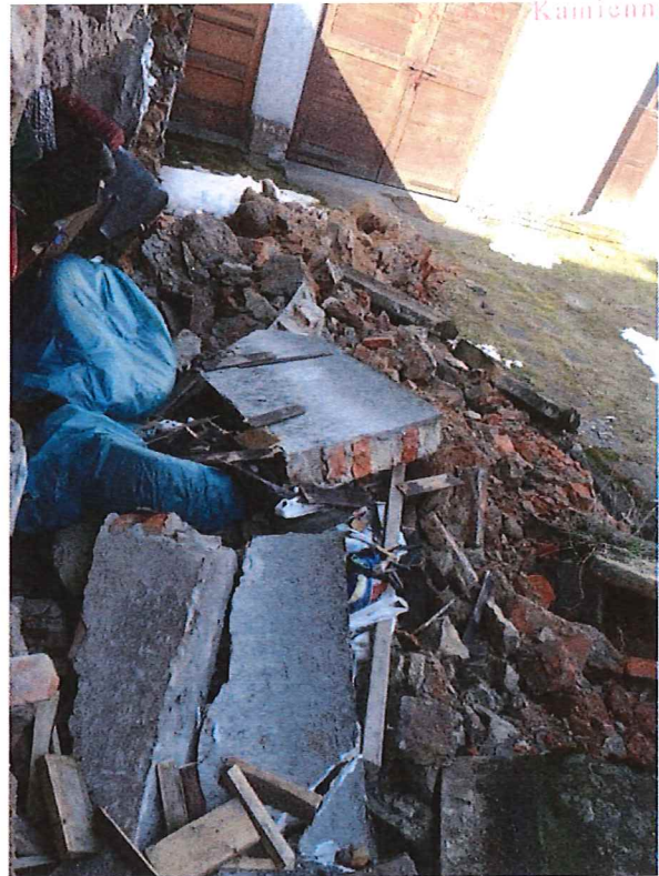
Fot. 5 – widok zawalonego obiektu od strony północnej
