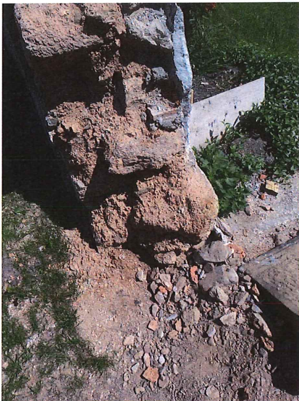
Fot. 6 – przekrój uszkodzonego muru
