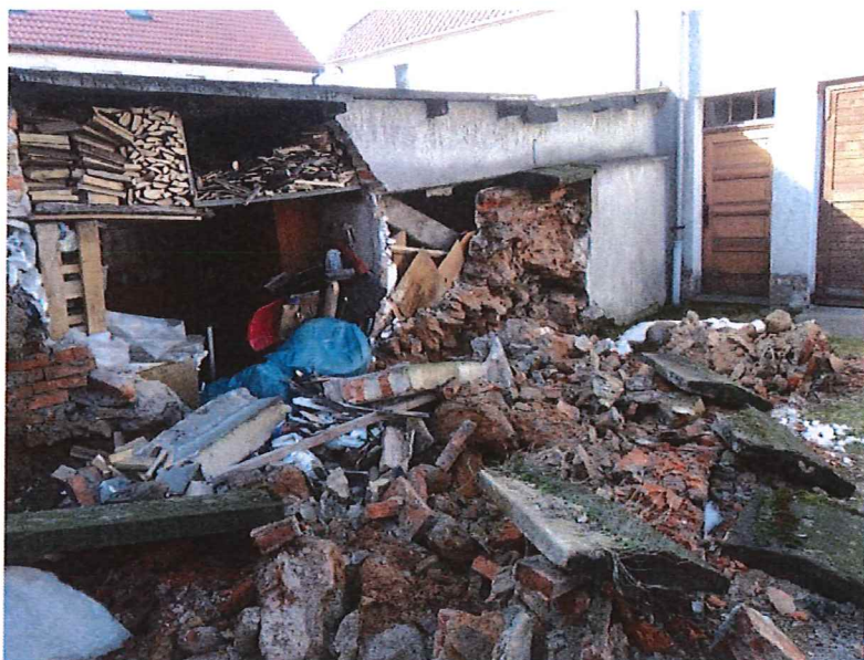
Fot. 1 – widok zawalonego obiektu od strony północnej
