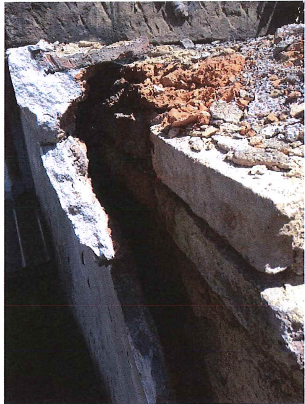
Fot. 7 – odspojony tynk muru
