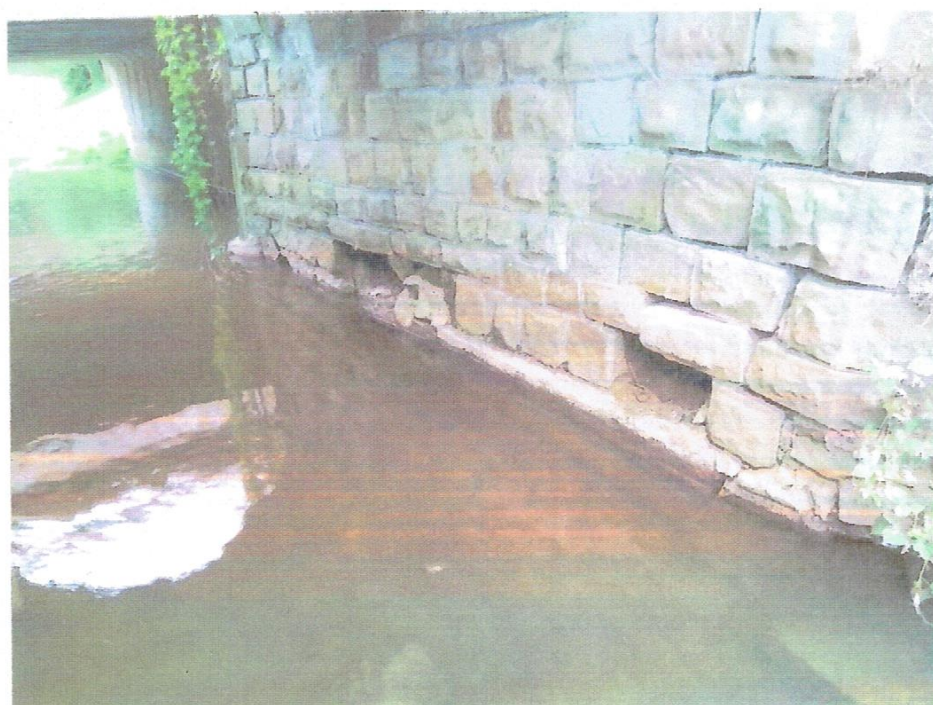
Zdj. 2. Ubytki elementów kamiennych w dolnej części korpusu przyczółka od str. południowej.
