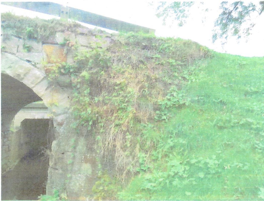
Zdj. 4. Wegetacja roślin na skrzydle przyczółka od str. południowej i dolnej wody.
