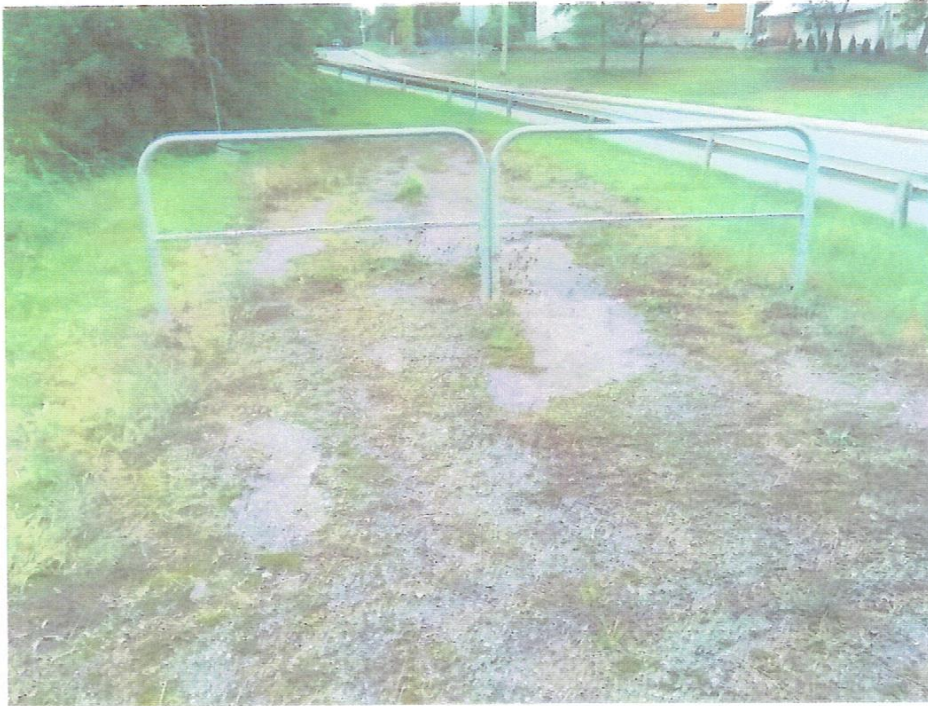
Zdj. 8. Zanieczyszczona i porośnięta roślinnością nawierzchnia bitumiczna dojazdów.
