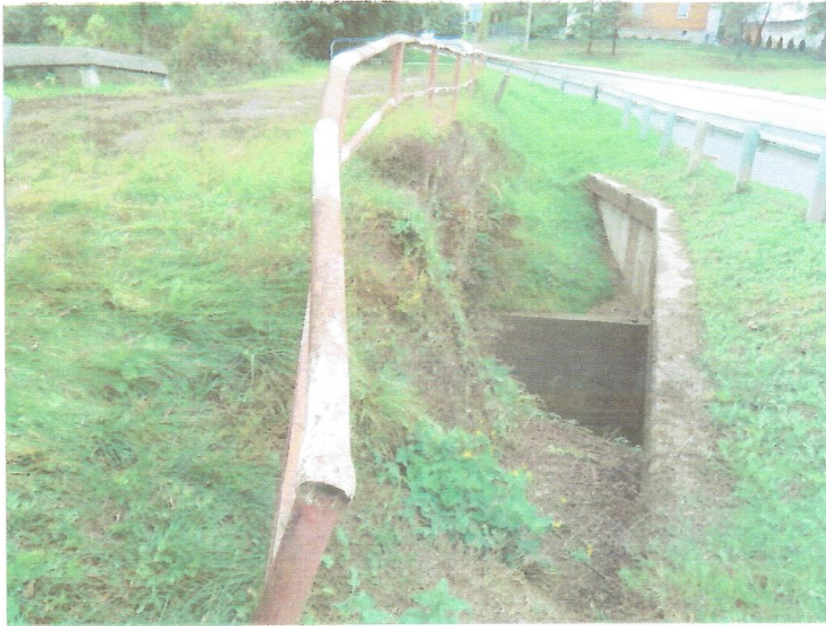
Zdj. 7. Przemieszczenie / pochylenie balustrada stalowa skutkujące utrata prostoliniowości.
