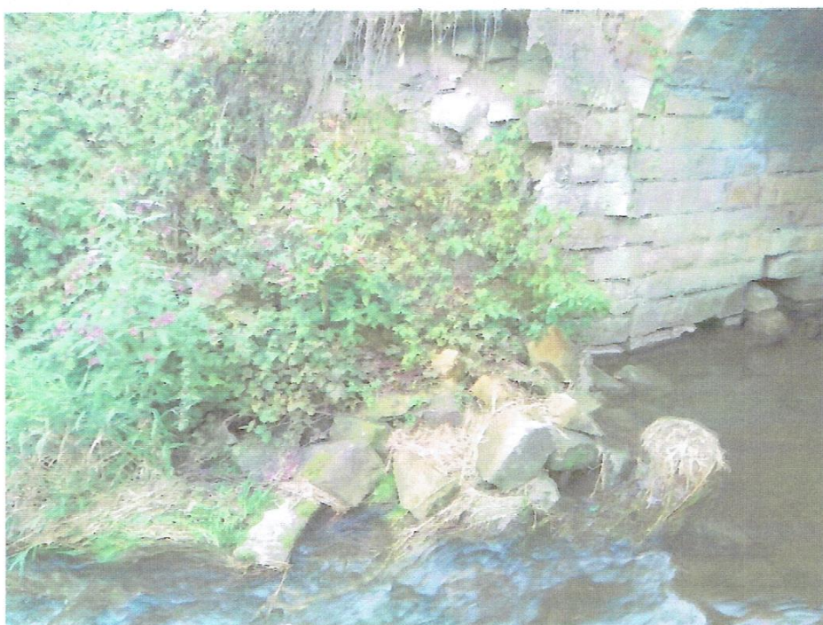
Zdj. 9. Zalegające kamienie znajdujące się w potoku – widok od str. dolnej wody.
