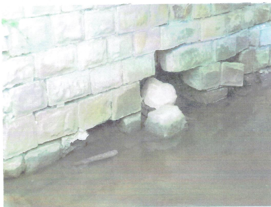
Zdj. 1. Ubytki elementów kamiennych w dolnej części korpusu przyczółka od str. północnej.
