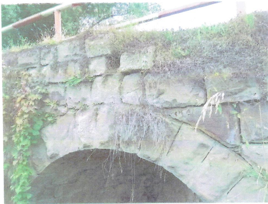
Zdj. 5. Ubytki materiału oraz braki w spoinowaniu na ścianie bocznej widoczne po obu stronach mostu.
