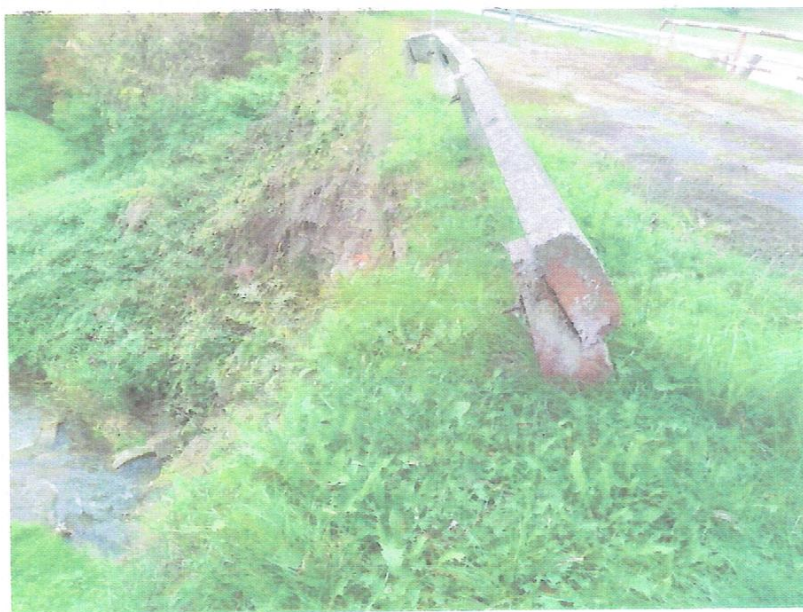
Zdj. 6. Przemieszczenie / pochylenie bariery betonowej.
