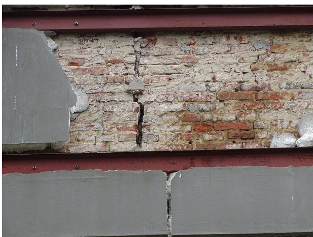
Fot 24 ściana północna – spękanie i rozwarstwienie
