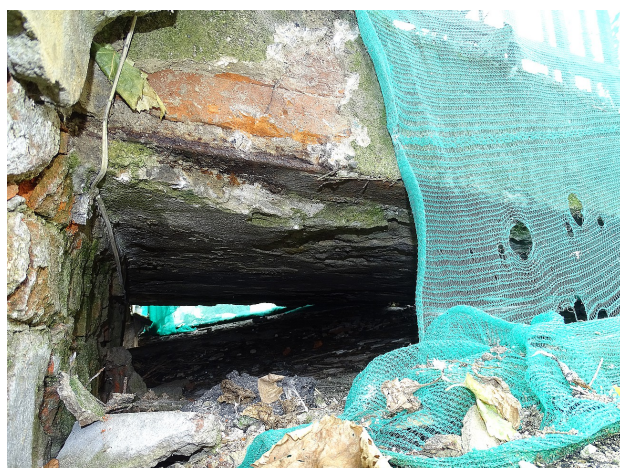
Fot 23 Balkon Ip narożnik północno-zachodni
