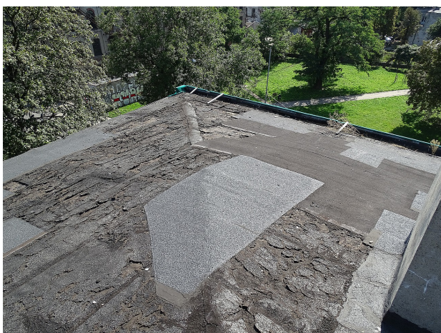
Fot 7 Dach -uszkodzona pokrycie papowe
