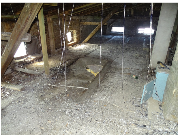
Fot 9 Uszkodzony strop poddasza
