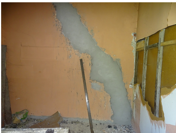
Fot 17 Pęknięcie ściana wewnętrzna lok 16 IIp -widok zab. pęknięcia
