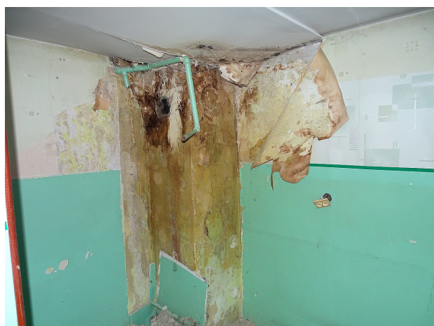
Fot 12 Zaciek przy kominie – pom. poddasza
