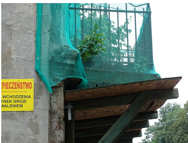
Fot 22 Balkon Ip narożnik północno-zachodni
