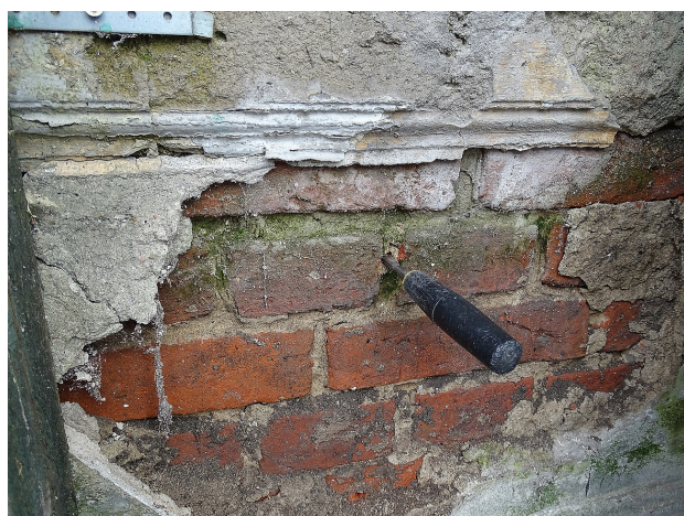
Fot 33 Badanie makroskopowe cegły i zaprawy, ściana zachodnia
