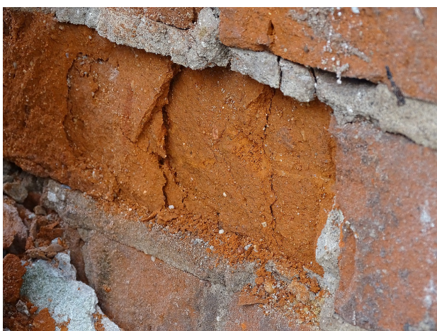
Fot 32 Badanie makroskopowe cegły i zaprawy, ściana zachodnia
