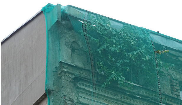
Fot 28 Elewacja zachodnia -uszkodzony gzyms
