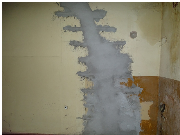
Fot 18 Pęknięcie ściana wewnętrzna lok 17 IIp -widok zab. pęknięcia
