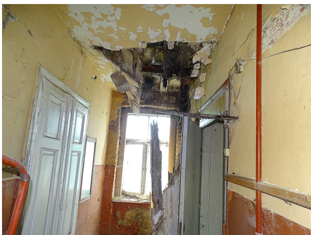
Fot 15 Uszkodzony strop poddasza - korytarz
