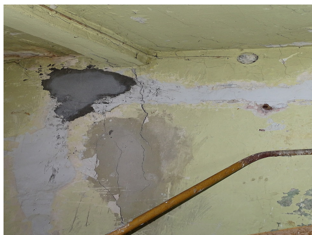
Fot 20 kl.schodowa – rysy i spękania - poddasze
