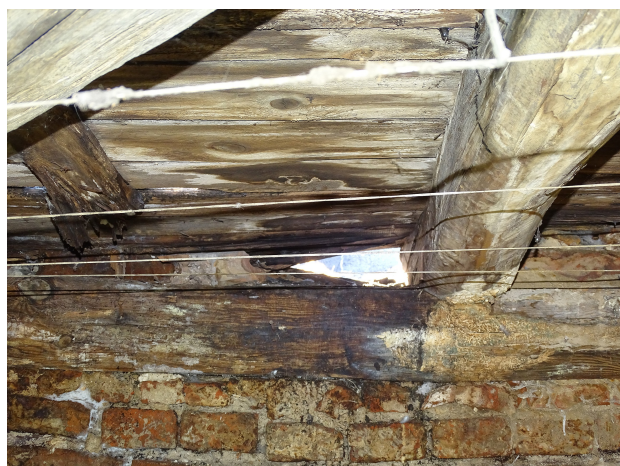
Fot 8 Uszkodzone deskowanie
