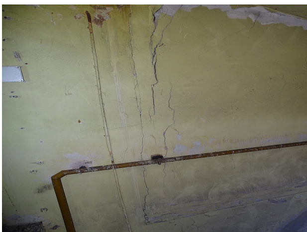
Fot 19 kl.schodowa – rysy i spękania - poddasze
