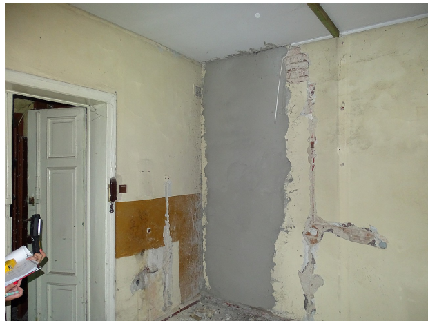
Fot 14 Ścian północna lok 17- IIp- widok zab. pęknięcia
