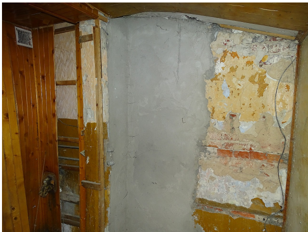
Fot 13 Ścian północna lok. 27 -poddasze widok zab. pęknięcia
