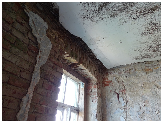
Fot 16 Uszkodzone nadproże lok 18 IIp
