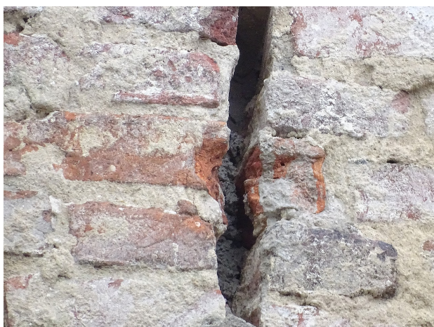
Fot 25 ściana północna – spękanie i rozwarstwienie
