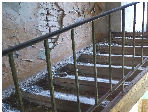
Fot 21 kl.schodowa – rysy i spękania
