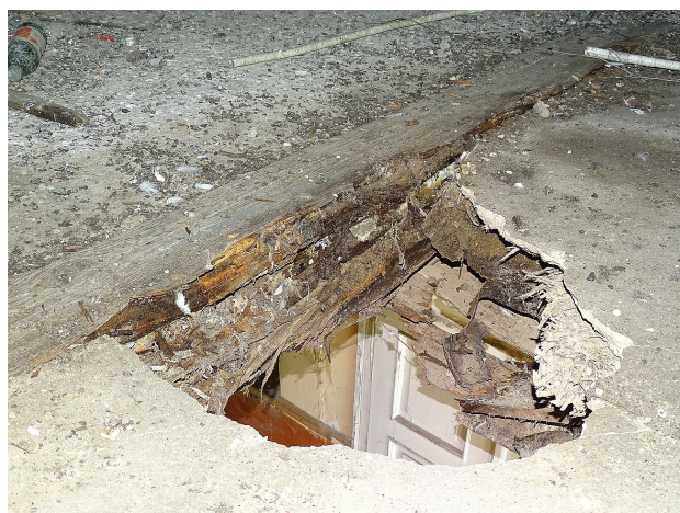
Fot 10 Uszkodzony strop poddasza
