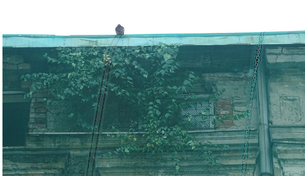
Fot 29 Elewacja zachodnia -uszkodzony gzyms
