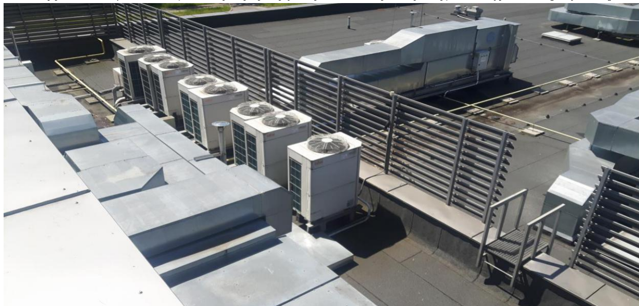
Zdjęcie nr 21 (dach nad przewiązką łączący część biurową z częścią produkcyjno - magazynową)
