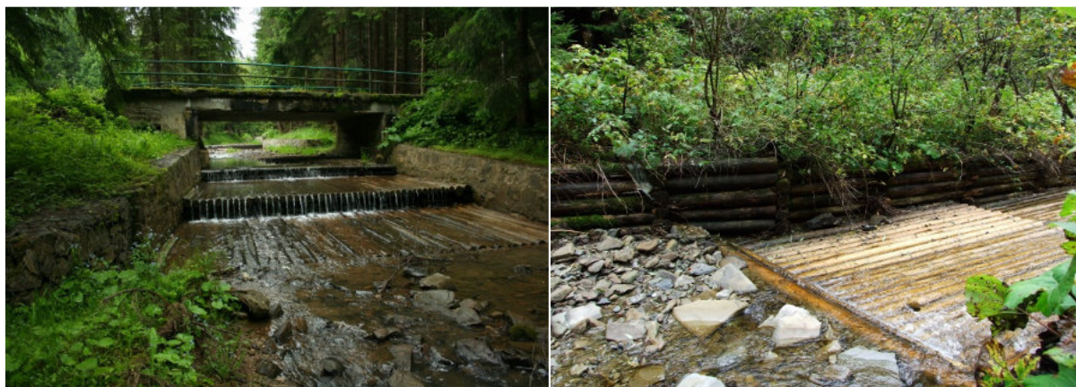
Stopnie wykonane z belek wzdłuż cieku przerywające ciągłość biologiczną. Źródło: Archiwum CKPS
