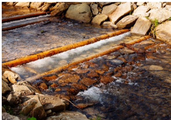
Gurt ubezpieczający próg – gurt zabezpieczony narzutem kamiennym – rozwiązanie podobne do rys na rycinie a) Źródło: Archiwum CKPŚ
