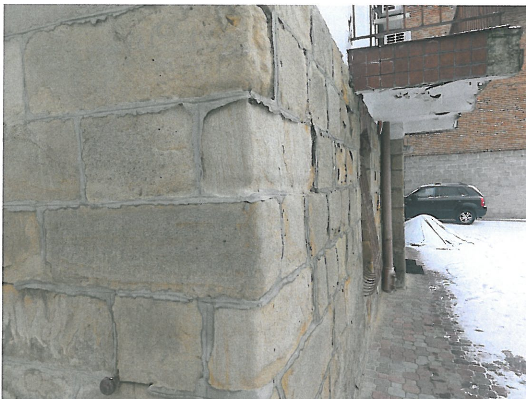
Fot. 2-10. Bochnia, kamienica przy ul. Kazimierza Wielkiego 26, program prac konserwatorskich. Elewacja boczna, zachodnia. Stan zachowania kamieni cokołowych w narożniku elewacji zachodniej i południowej. Widoczne ubytki lica na kamieniach wskutek oddziaływania soli, migrującej wraz z wodą z wnętrza muru ku powierzchni oraz z zastosowanej niefachowo, mocnej zaprawy na bazie cementu.
