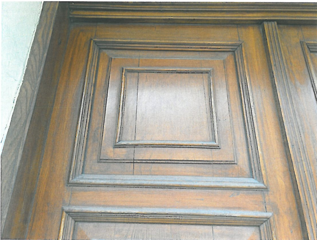
Fot. 4-05. Bochnia, kamienica przy ul. Kazimierza Wielkiego 26, program prac konserwatorskich. Widok dolnego fragmentu skrzydła prawego w elewacji frontowej północnej., widoczne ubytki i przetarcia powłoki malarskiej
