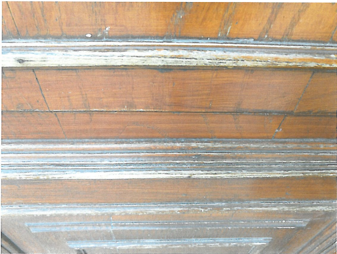
Fot. 4-07. Bochnia, kamienica przy ul. Kazimierza Wielkiego 26, program prac konserwatorskich. Widok ze zbliżenia na stan zachowania drzwi., widoczne ubytki i przetarcia powłoki malarskiej na profilowanych gzymsach.
