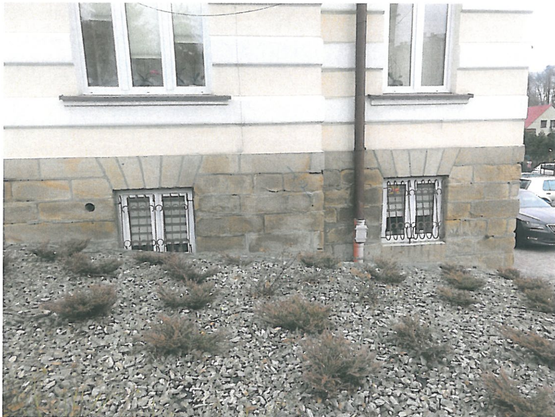
Fot. 2-04. Bochnia, kamienica przy ul. Kazimierza Wielkiego 26, program prac konserwatorskich. Elewacja boczna, zachodnia, fragment cokołu kamiennego od strony południowej (ryzalit i ściana od strony południowej). Widoczne ubytki lica kamieni cokołowych i wykruszenie cementowej zaprawy.
