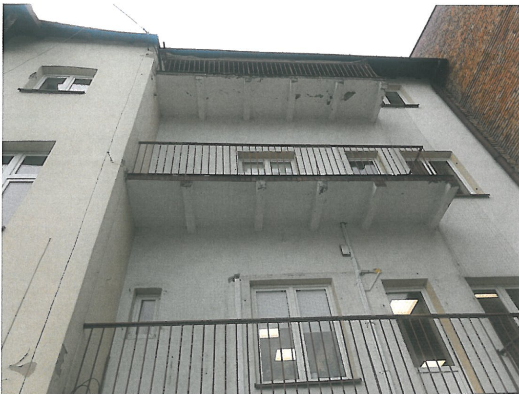
Fot. 3-11. Bochnia, kamienica przy ul. Kazimierza Wielkiego 26, program prac konserwatorskich. Elewacja tylna, południowa, ściana po prawej stronie ryzalitu. Widoczne uszkodzenia betonowych płyt balkonowych. Rozplanowanie okien zmieniono w trakcie generalnego remontu w roku 1970.
