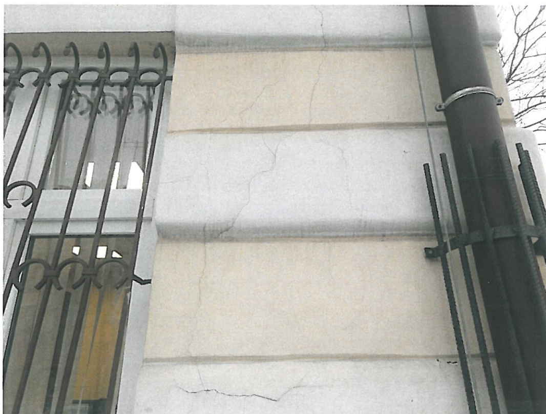
Fot. 1-11. Bochnia, kamienica przy ul. Kazimierza Wielkiego 26, program prac konserwatorskich. Elewacja północna, narożnik zachodni. Widoczna spękania pasów boni, wierzchniej szlichty i farby.
