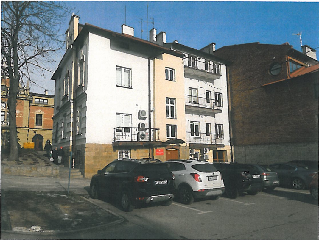
Fot. 3-01. Bochnia, kamienica przy ul. Kazimierza Wielkiego 26, program prac konserwatorskich. Elewacja tylna, południowa, widok ogólny lokalizacji kamienicy.
