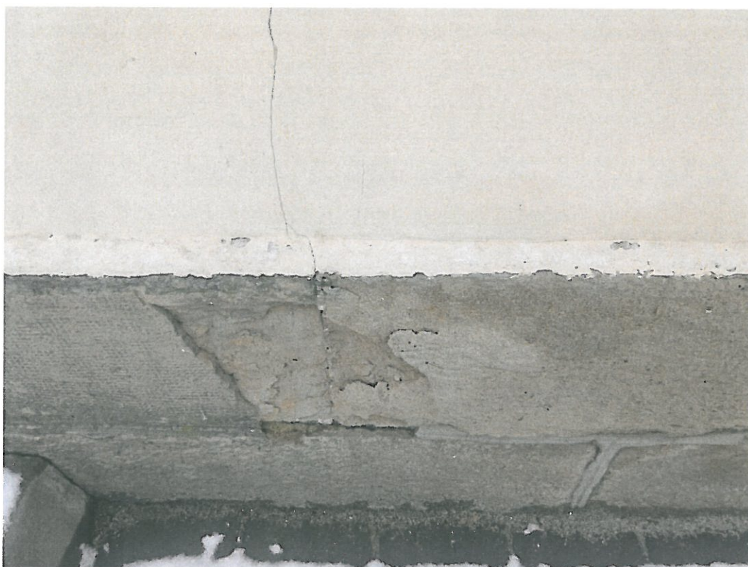
Fot. 2-06. Bochnia, kamienica przy ul. Kazimierza Wielkiego 26, program prac konserwatorskich. Elewacja boczna, zachodnia, ujęcie detaliczne obrazujące stan zniszczenia kamieni cokołowych i zaprawy w fugach, fragment po lewej stronie ryzalitu.
