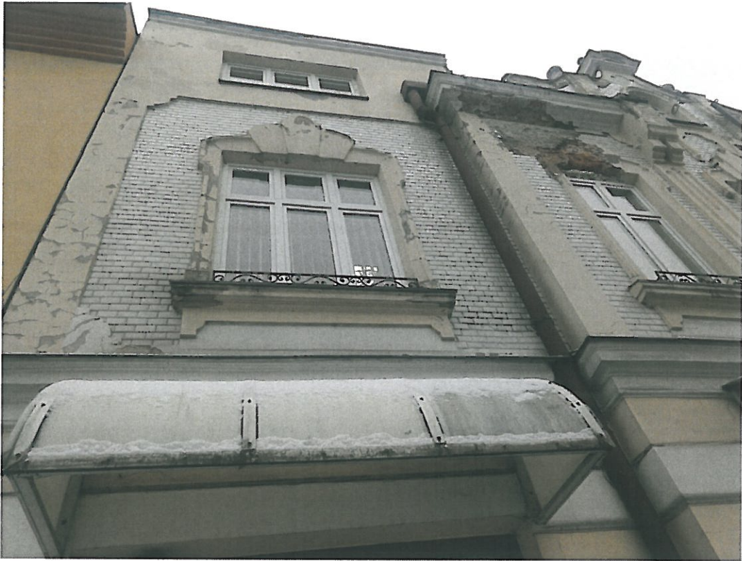
Fot. 1-13. Bochnia, kamienica przy ul. Kazimierza Wielkiego 26, program prac konserwatorskich. Elewacja północna. Widoczne skala zniszczenia gzymsu.
