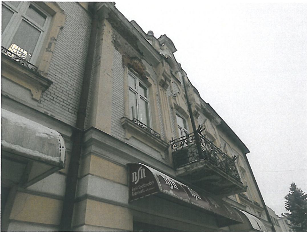
Fot. 1-14. Bochnia, kamienica przy ul. Kazimierza Wielkiego 26, program prac konserwatorskich. Elewacja północna, Widoczna skala zniszczenia wystroju architektonicznego oraz okładziny z glazurowanych płytek ceramicznych.
