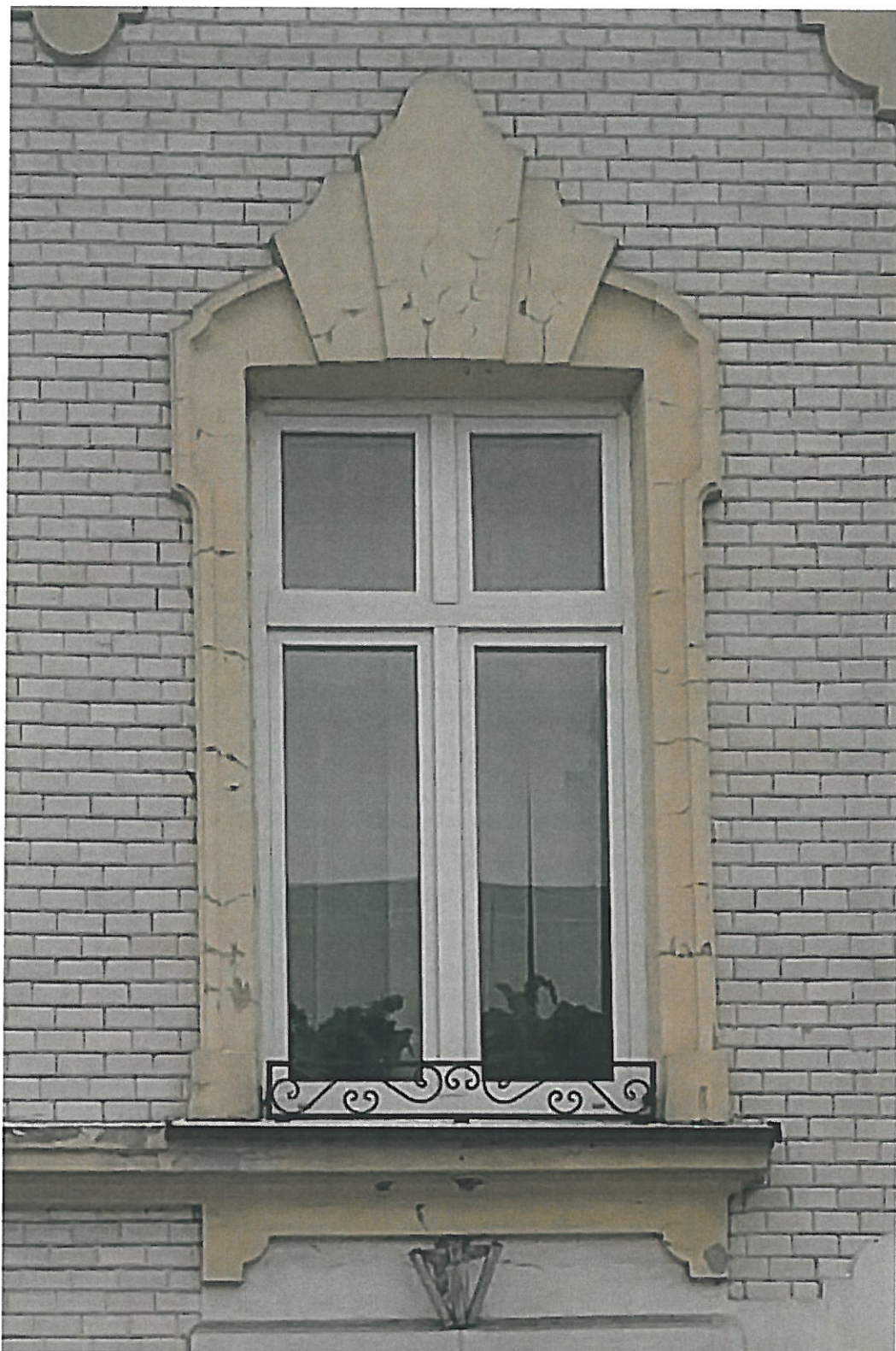
Fot. 1-16. Bochnia, kamienica przy ul. Kazimierza Wielkiego 26, program prac konserwatorskich. Elewacja północna, obramienie okna ze stolarką dwu kwaterową. Widoczny zakres zniszczeń:
