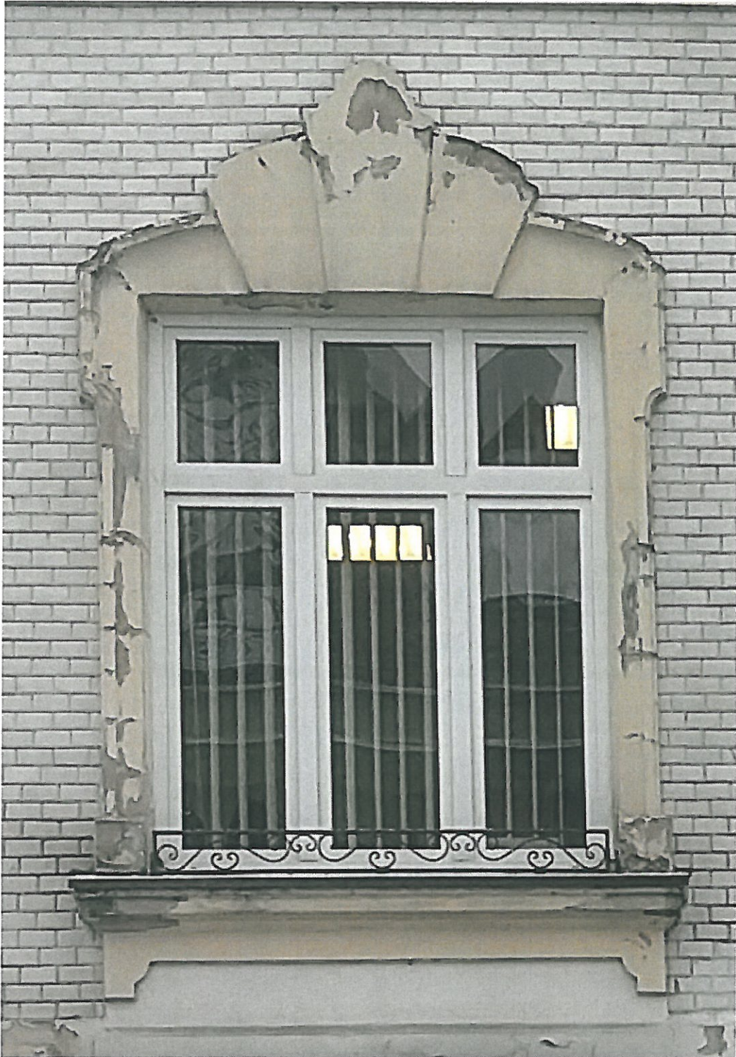
Fot. 1-15. Bochnia, kamienica przy ul. Kazimierza Wielkiego 26, program prac konserwatorskich. Elewacja północna, obramienie okna ze stolarką trój kwaterową. Widoczny zakres zniszczeń:
