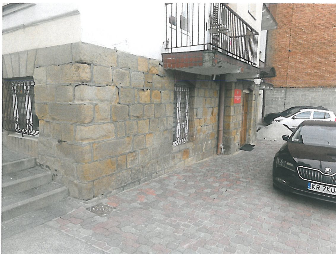
Fot. 3-03. Bochnia, kamienica przy ul. Kazimierza Wielkiego 26, program prac konserwatorskich. Elewacja tylna, południowa, aktualny stan zachowania cokołu kamiennego.
