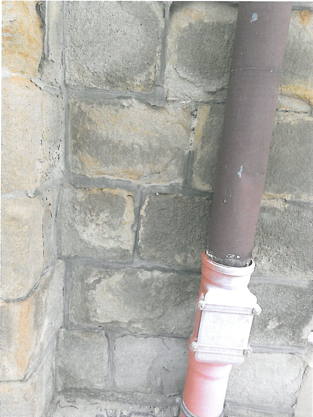
Fot. 2-10. Bochnia, kamienica przy ul. Kazimierza Wielkiego 26, program prac konserwatorskich. Elewacja boczna, zachodnia. Stan zachowania kamieni cokołowych na połączeniu ryzalitu i ścianą południową elewacji zachodniej. Widoczna daleko posunięta destrukcja, spowodowana przez sole, migrujące wraz z wodą z zapraw cementowych ku powierzchni kamieni. Zniszczenie powoduje także wysalanie w strukturze cokołu, w szczelinach i rozstępach, jakie powstały wskutek oddziaływania procesu stokowego.
