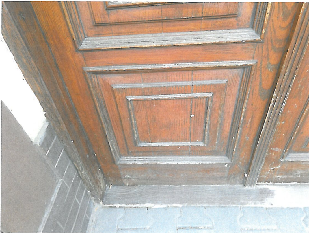
Fot. 4-03. Bochnia, kamienica przy ul. Kazimierza Wielkiego 26, program prac konserwatorskich. Widok dolnego fragmentu skrzydła lewego w elewacji frontowej północnej., widoczne ubytki i przetarcia powłoki malarskiej
