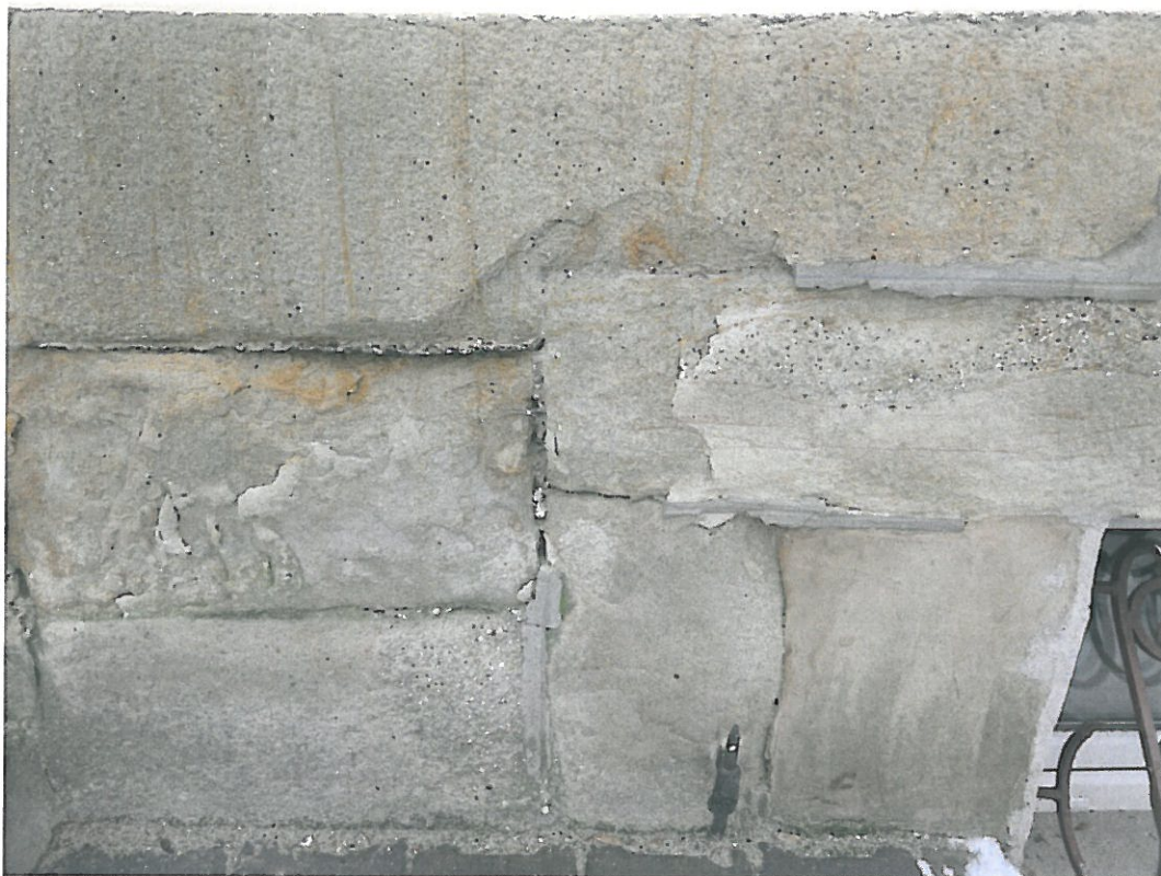
Fot. 2-05. Bochnia, kamienica przy ul. Kazimierza Wielkiego 26, program prac konserwatorskich. Elewacja boczna, zachodnia, ujęcie detaliczne obrazujące stan zniszczenia kamieni cokołowych i zaprawy w fugach.
