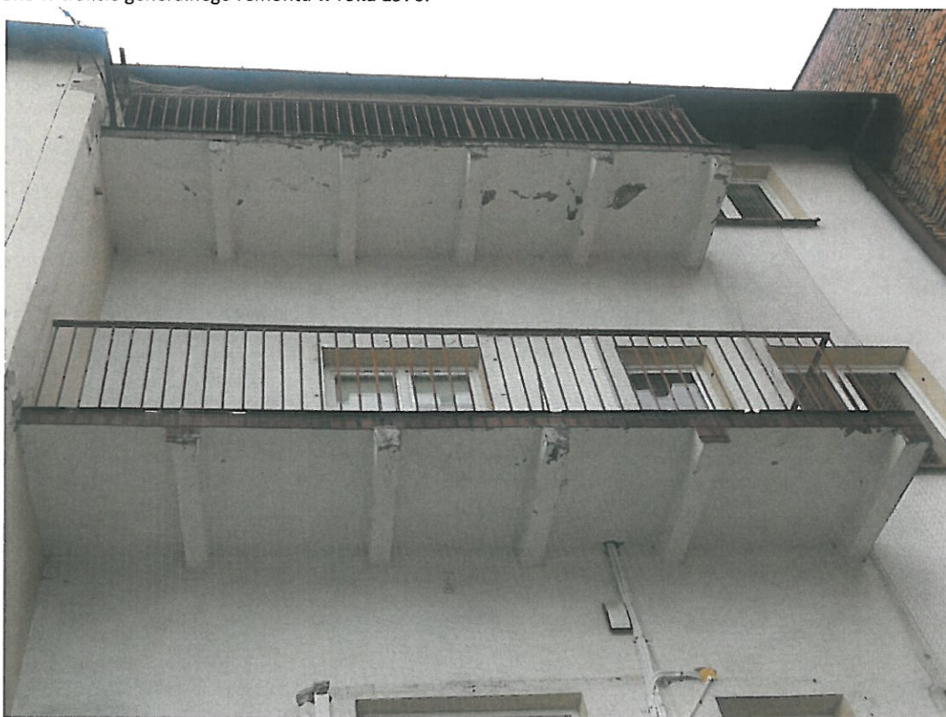
Fot. 3-12. Bochnia, kamienica przy ul. Kazimierza Wielkiego 26, program prac konserwatorskich. Elewacja tylna, południowa, ściana po prawej stronie ryzalitu. Widoczne uszkodzenia betonowych płyt balkonowych
