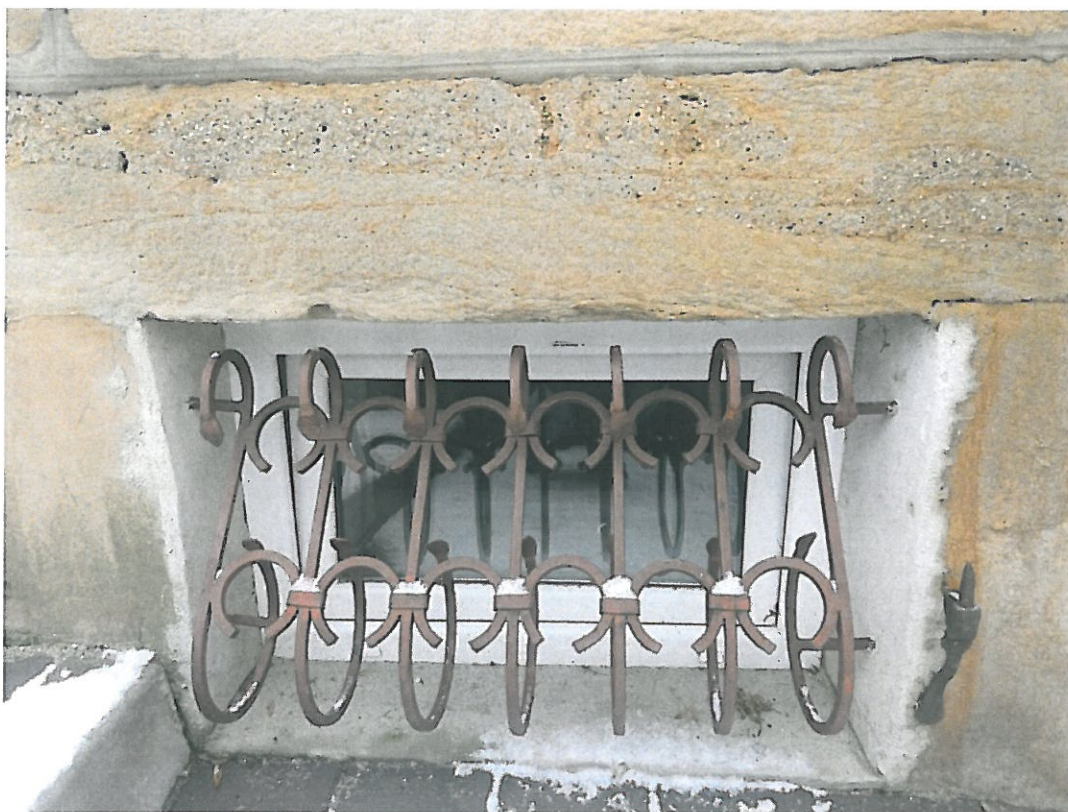
Fot. 2-07. Bochnia, kamienica przy ul. Kazimierza Wielkiego 26, program prac konserwatorskich. Elewacja boczna, zachodnia, fragment cokołu kamiennego po lewej stronie ryzalitu z przebitym wtórnie oknem do piwnicy.
