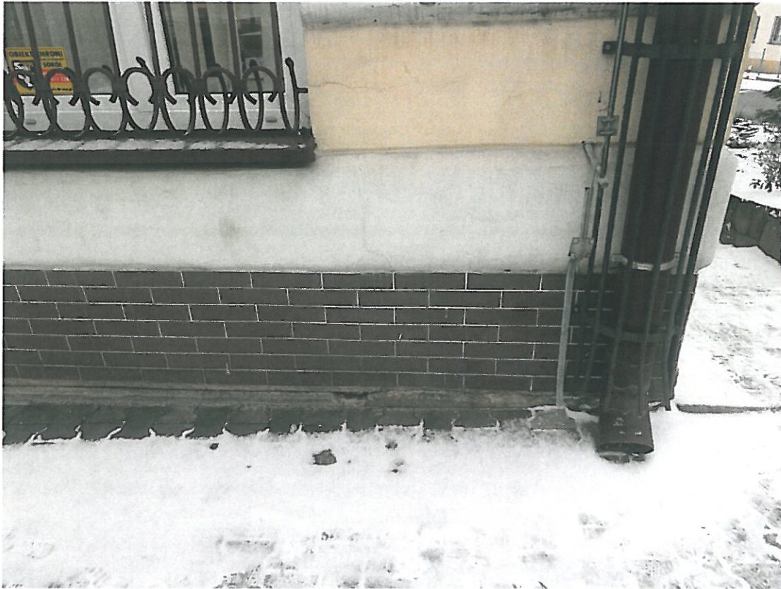
Fot. 1-07. Bochnia, kamienica przy ul. Kazimierza Wielkiego 26, program prac konserwatorskich. Elewacja północna, narożnik zachodni w przyziemiu. Widoczna okładzina ceramiczna dolnego pasa boni. Element do usunięcia.
