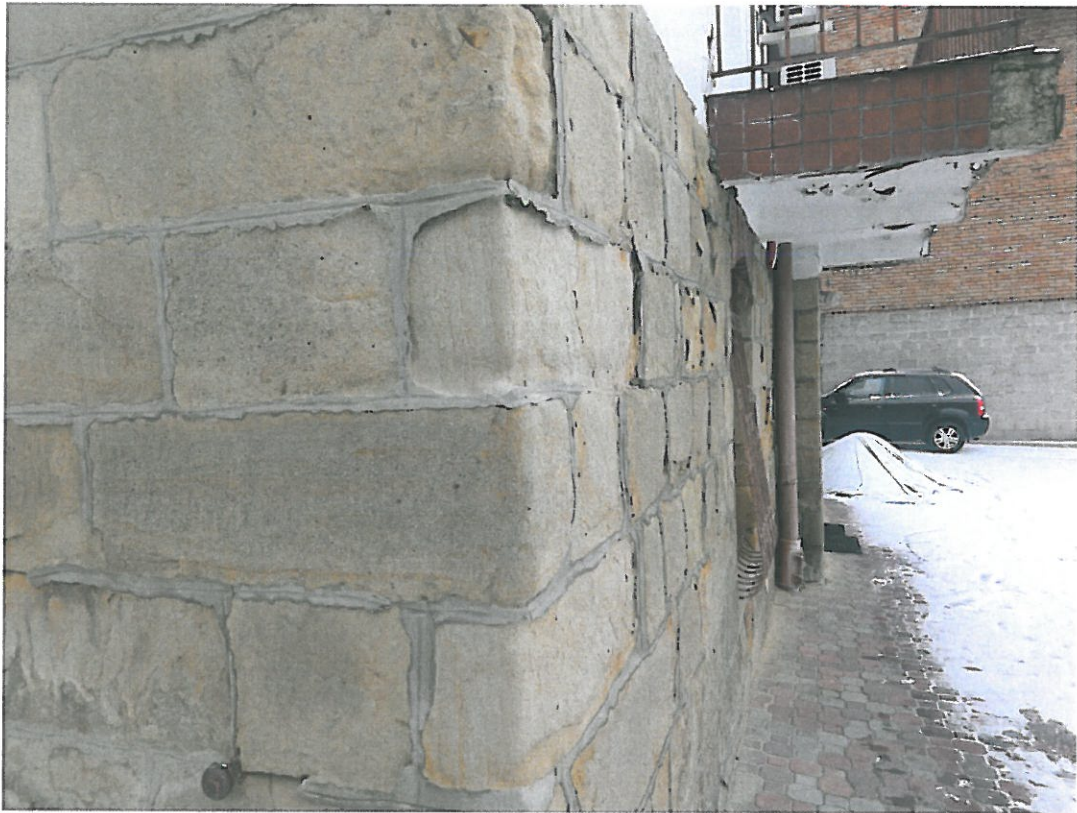
Fot. 3-09. Bochnia, kamienica przy ul. Kazimierza Wielkiego 26, program prac konserwatorskich. Elewacja tylna, południowa,
