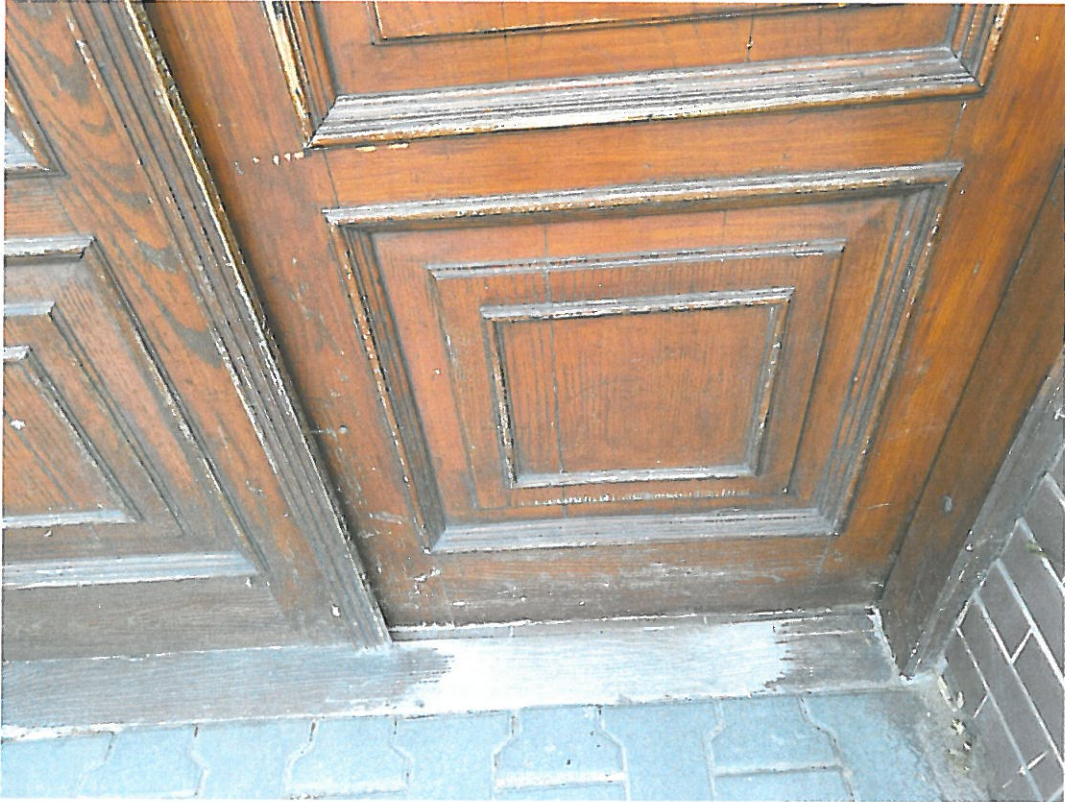
Fot. 4-02. Bochnia, kamienica przy ul. Kazimierza Wielkiego 26, program prac konserwatorskich. Widok dolnego fragmentu skrzydła prawego w elewacji frontowej północnej., widoczne ubytki i przetarcia powłoki malarskiej
