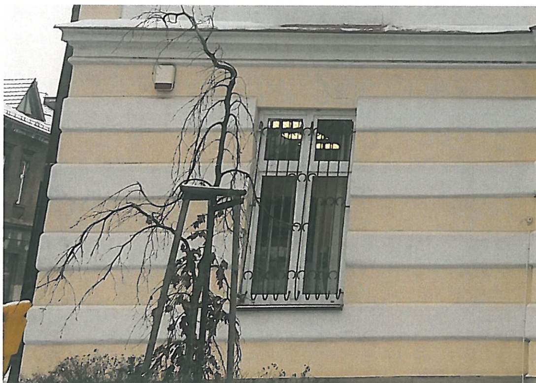
Fot. 2-12. Bochnia, kamienica przy ul. Kazimierza Wielkiego 26, program prac konserwatorskich. Elewacja boczna, zachodnia. Fragment boniowania w pasie kondygnacji parterowej. Okno wybite wtórnie w czasie remontu kapitalnego, na wzór oryginalnego.
