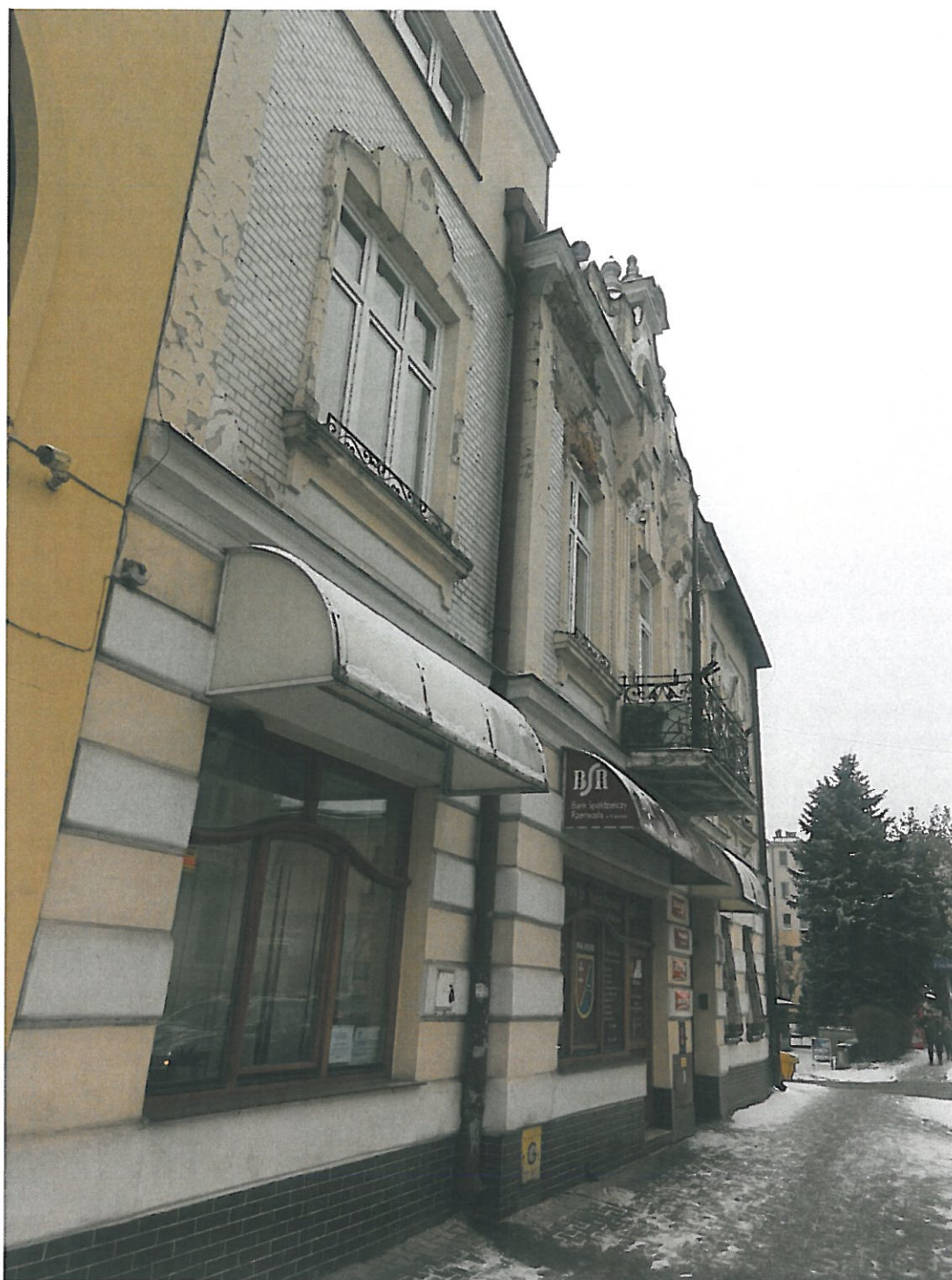
Fot. 1-12. Bochnia, kamienica przy ul. Kazimierza Wielkiego 26, program prac konserwatorskich. Elewacja północna, widoczny stan zniszczeń, takich jak:
