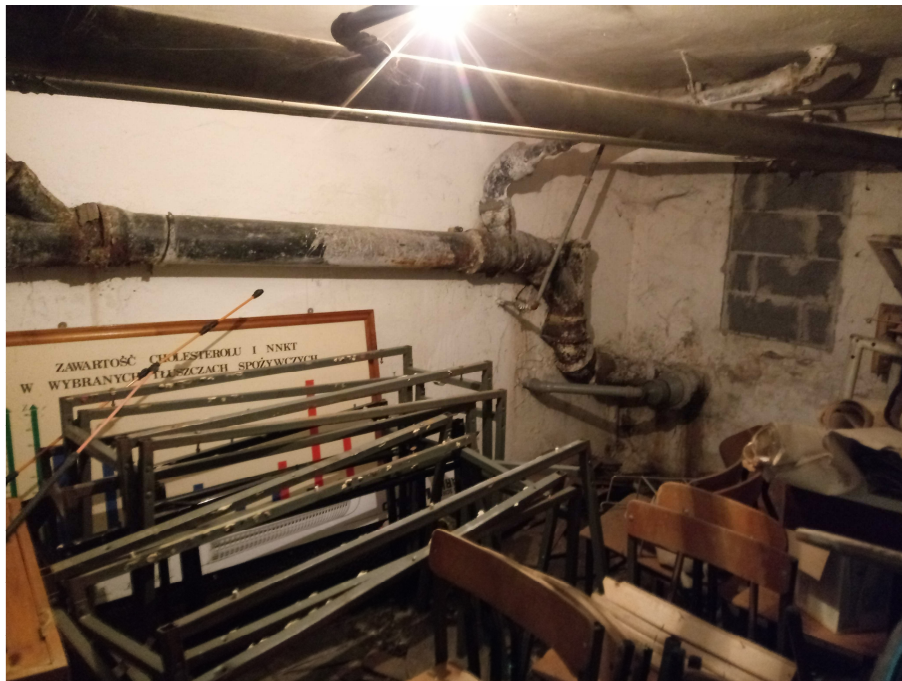
3.6 Wnętrze. Piwnica – fragment instalacji wod. – kan.
